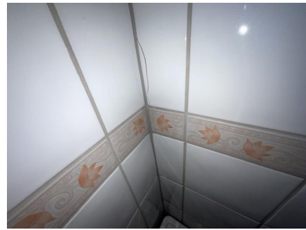
Sprekker i fliser i våtsonen.
