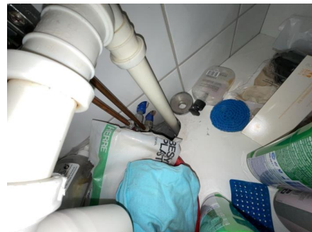
Utette rørgjennomføringer i våtsonen.
