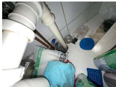
Utette rørgjennomføringer i våtsonen.
