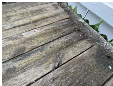
Råte i enkelte terrassebord.
