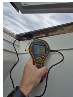
Målt noe høye fuktverdiger i takvindu.
