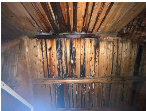
Bilde viser sylig fuktig takkonstruksjon, fra pågående lekkasje.
