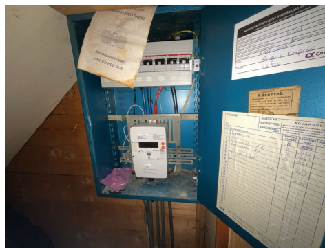
Sikringsskap er plassert på bod 2 etasje.
