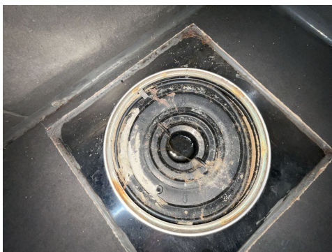
Bilde viser sluk i dusj.
