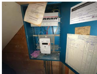
Sikringsskap er plassert på bod 2 etasje.
