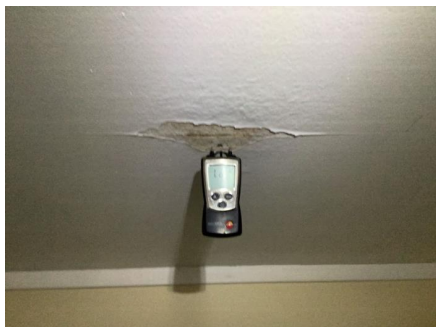
Svellskadet himlingsplate måles tørr.
