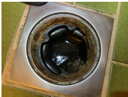
Plastsluk, og det er ikke synlig tettesjikt rundt sluk.
