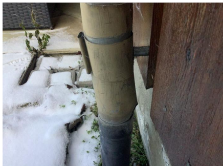
Eksempel på frostsprengt nedløpsrør.
