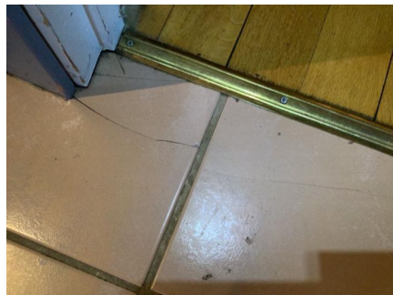
Sprukne gulvfliser på kjøkken.
