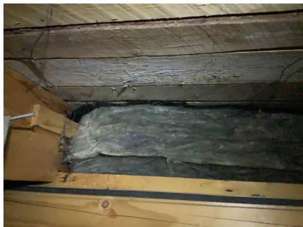
Luftespalte over isolasjon er tilnærmet sperret av isolasjon.
