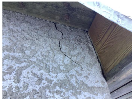
Sprekkdannelse i murvegg.
