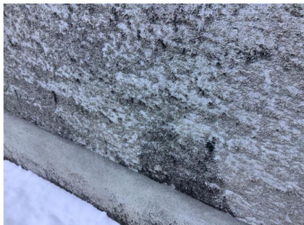
Mosegroing på murvegg.
