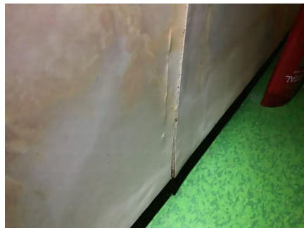
Baderomsplate er fuktskadet.
