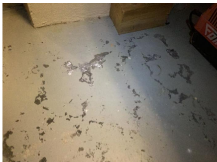
Eksempel på saltutslag på betonggulv.
