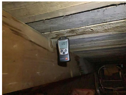
Fuktskjolder i taktro måles tørre.
