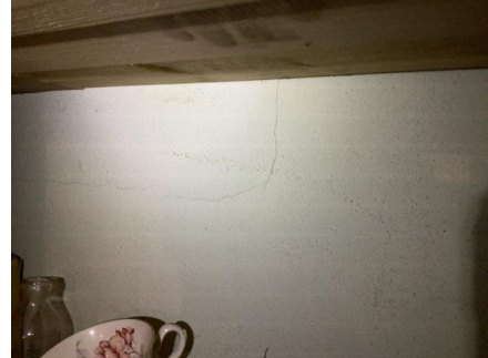
Eksempel på innvendig horisontalriss.
