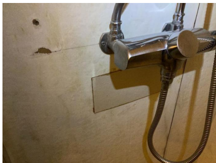
Skader i baderomsplate i dusjhjørnet.
