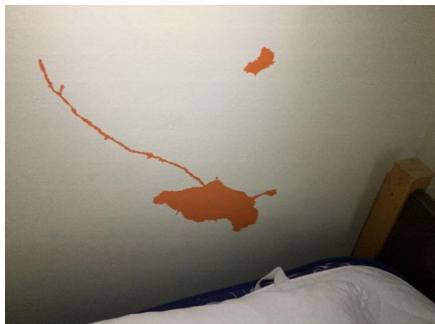
Løstnet maling fra vegg på soverom.
