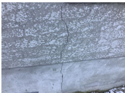
Sprekkdannelse på murvegg.
