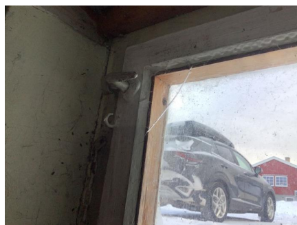
Sprukket glass i vindu.
