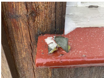
Omremming rundt vindu er ført helt ned til vannbrett.
