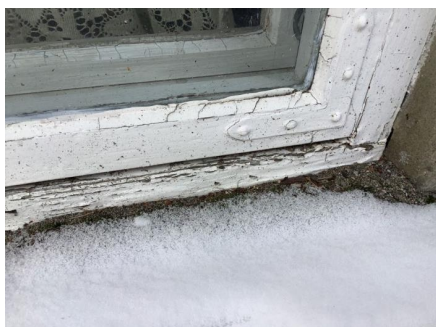
Eksempel på værslitt vindu.
