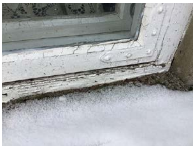
Eksempel på værslitt vindu.
