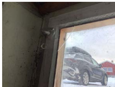
Sprukket glass i vindu.
