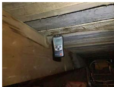
Fuktskjolder i taktro måles tørr.
