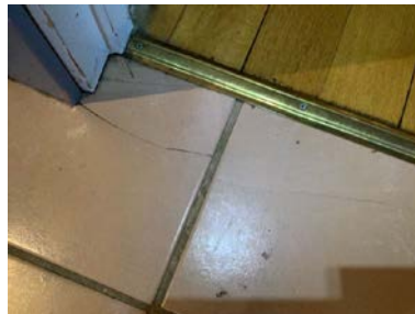
Sprukne gulvfliser på kjøkken.
