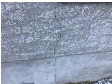
Sprekkdannelse på murvegg.
