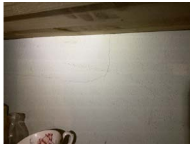
Eksempel på innvendig horisontalriss.
