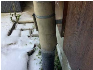
Eksempel på frostsprengt nedløpsrør.
