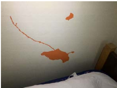
Løstnet maling fra vegg på soverom.
