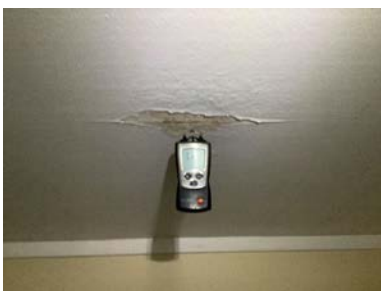
Svellskadet himlingsplate måles tørr.
