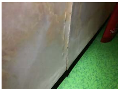
Baderomsplater er fuktskadet.
