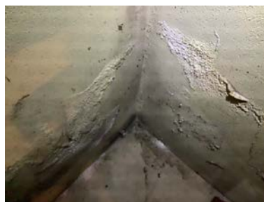
Eksempel på saltutslag på murvegg.
