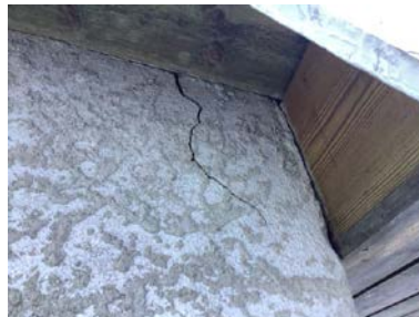
Sprekkdannelse i murvegg.
