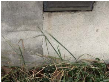
Eksempel på utvendig skråriss.
