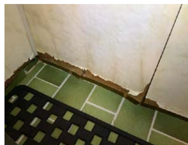
Baderomsplater er fuktskadet i dusjhjørnet.
