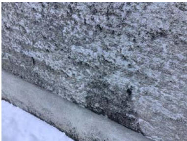
Mosegroing på murvegg.
