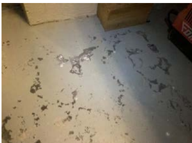
Eksempel på saltutslag på betonggulv.
