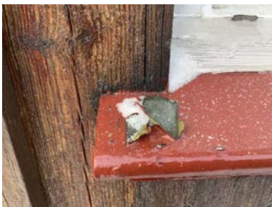
Omremming rundt vindu er ført helt ned til vannbrett.
