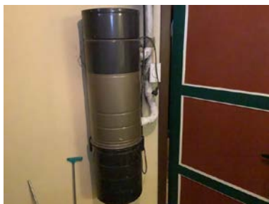
Defekt motor på sentralstøvsuger.
