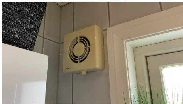
Elektrisk styrt vifte.
