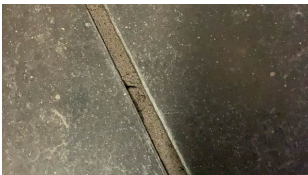
Eksempel på riss/sprekker i flisfuger i våtsone.
