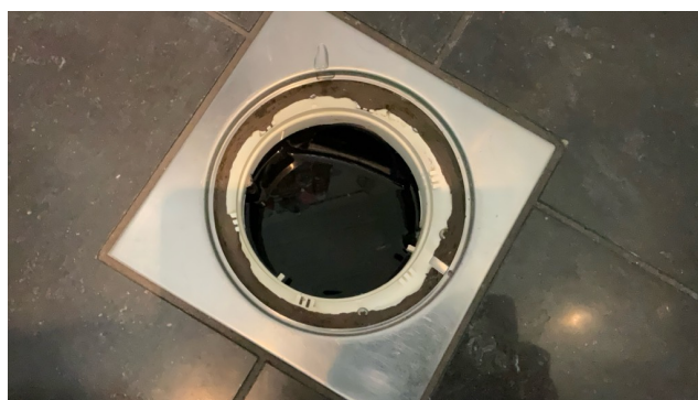
Plastsluk uten synlig mansjett under klemring.
