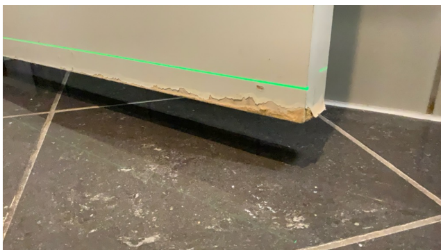
Eksempel på svelleskader i dørblad.
