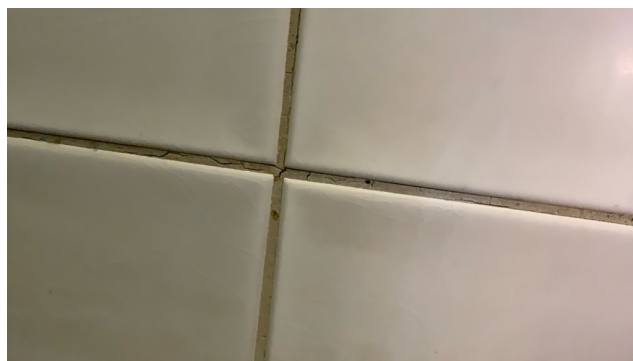
Eksempel på sprekker i flisfuger i våtsone.
