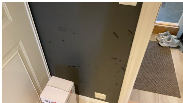
Eksempel på malingsflekker på vegg.
