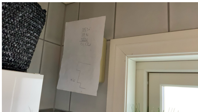
Ark henger på avtrekksventil. Bra avtrekk.
