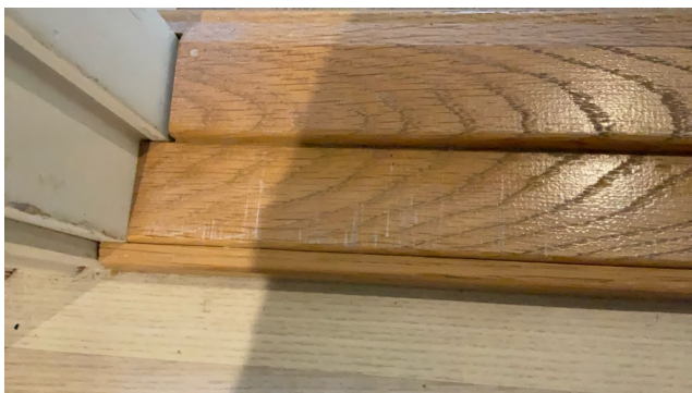
Eksempel på at dørblad tar i karm/terskel ved åpning/lukking.
