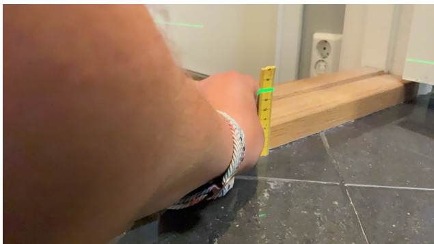
Det er målt 7cm på gulv ved terskel.
