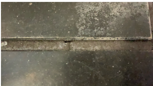
Eksempel på riss/sprekker i flisfuger i våtsone.
