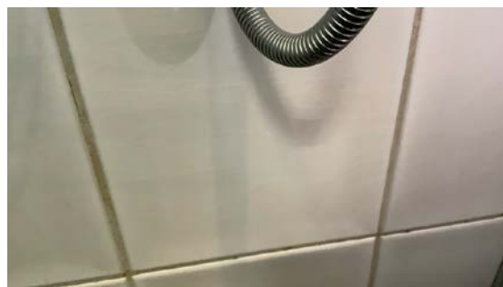
Eksempel på riss/sprekker i fliser i våtsone.
