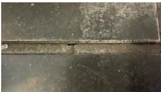
Eksempel på riss/sprekker i flisfuger i våtsone.
