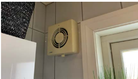
Elektrisk styrt vifte.
