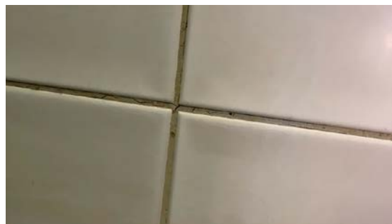
Eksempel på sprekker i flisfuger i våtsone.
