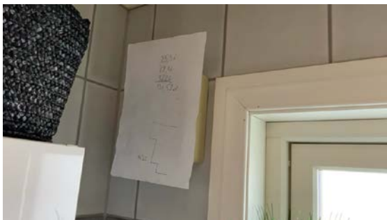
Ark henger på avtrekksventil. Bra avtrekk.
