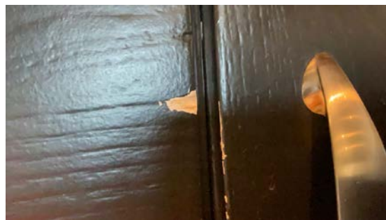
Eksempel på skader/hakk i kjøkkenfronter.
