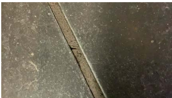
Eksempel på riss/sprekker i flisfuger i våtsone.
