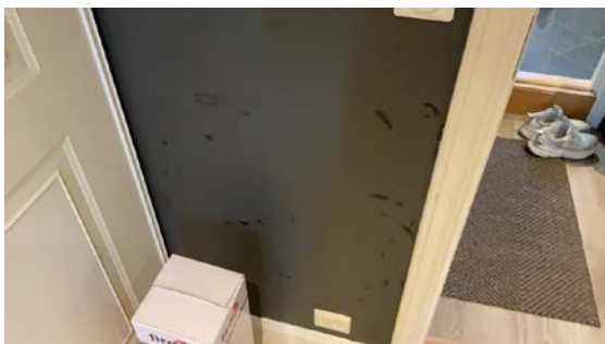
Eksempel på malingsflekker på vegg.
