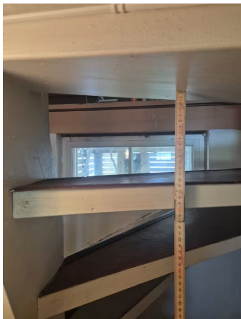
Viser åpninger mellom trinn.
