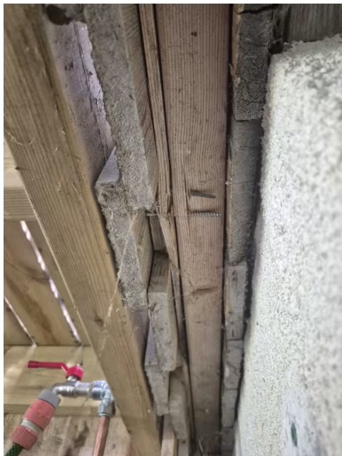
Viser innfesting av konstruksjon (kantbjelke), kun skrudd i panel.
