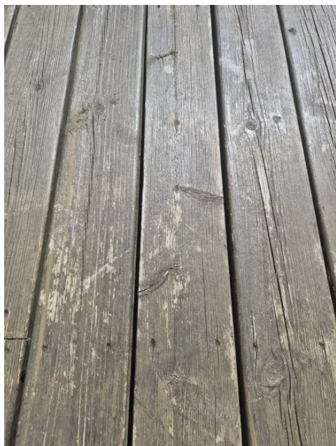
Viser terrassegulv med behov for overflatebehandling.
