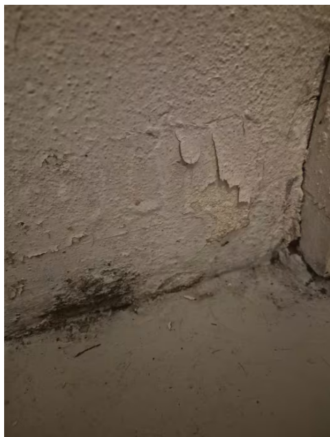
Viser eksempel av salt/kalutslag på innvendig vegger i kjeller.
