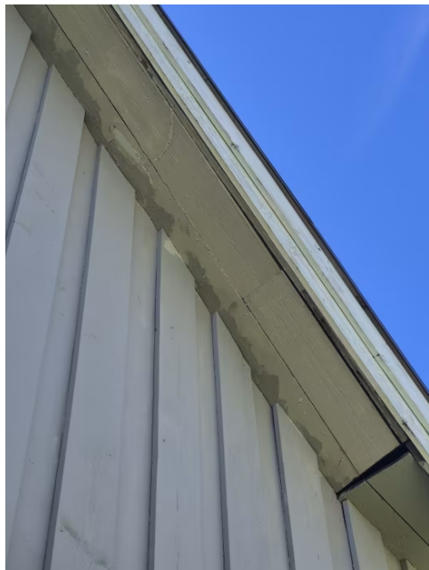
Viser gesimskasse og vindskier med manglende overflatebehandling.
