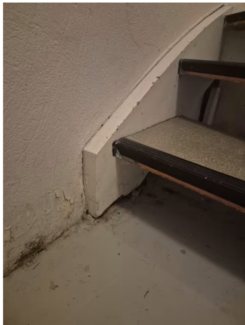
Viser skader i nedre del av kjellertrapp pga fuktopptrekk fra kjellergulv/grunnmur.
