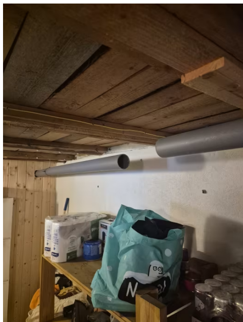
Viser område hvor avløpsrør er kappet.
