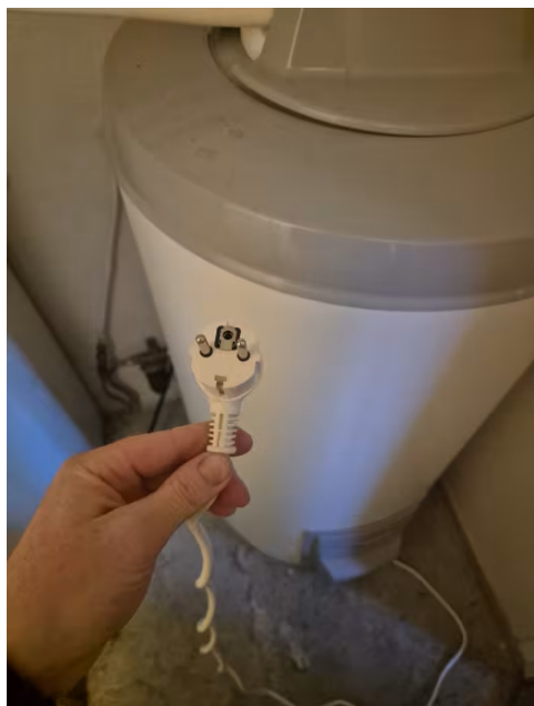
Viser plugg/støpsel, ingen tegn til varmegang.
