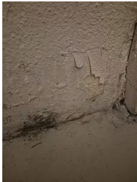
Viser eksempel av område i kjeller med sultfatskade (salt/kalkutslag).
