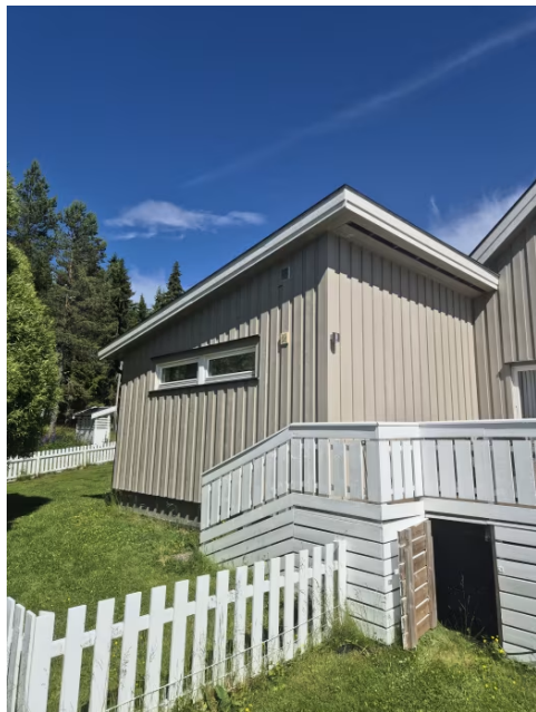
Viser raftekasse og vindskier med manglende overflatebehandling.
