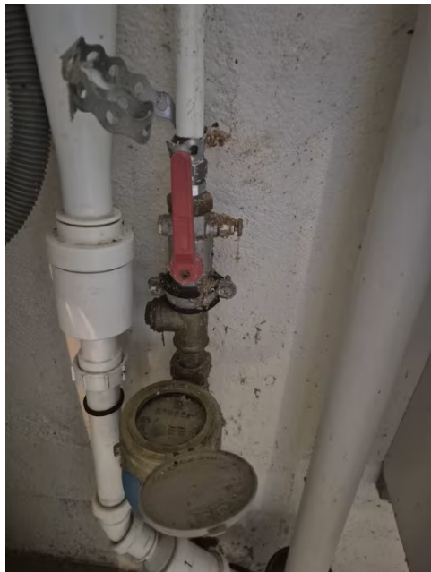
Viser plassering av hovedstoppekran i kjeller.
