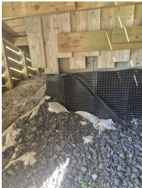
Viser område med manglende topplist.
