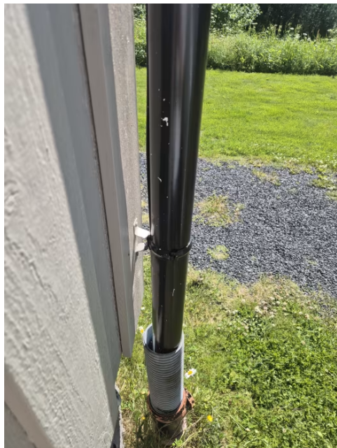
Viser nedløpsrør med buling/skade.
