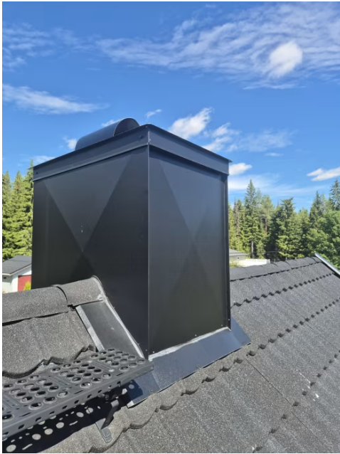
Viser helbeslått pipe på tak.
