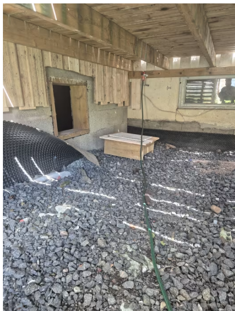
Viser område med manglende topplist.
