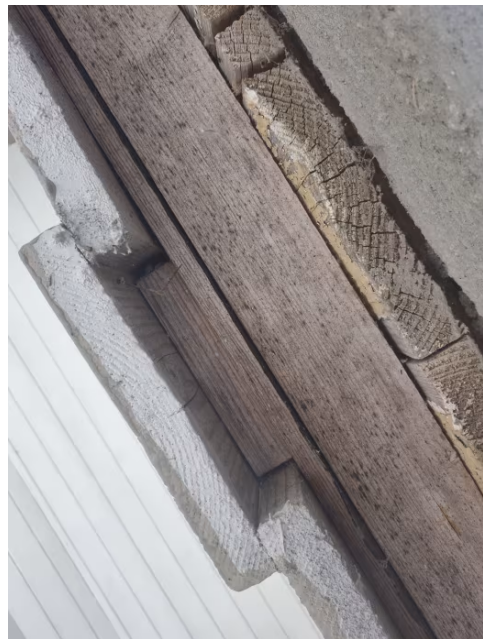
Viser eksempel av manglende lufting av kledning.
