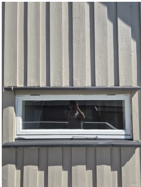
Viser eksempel på kort avstand mellom kledning og vannbrett.
