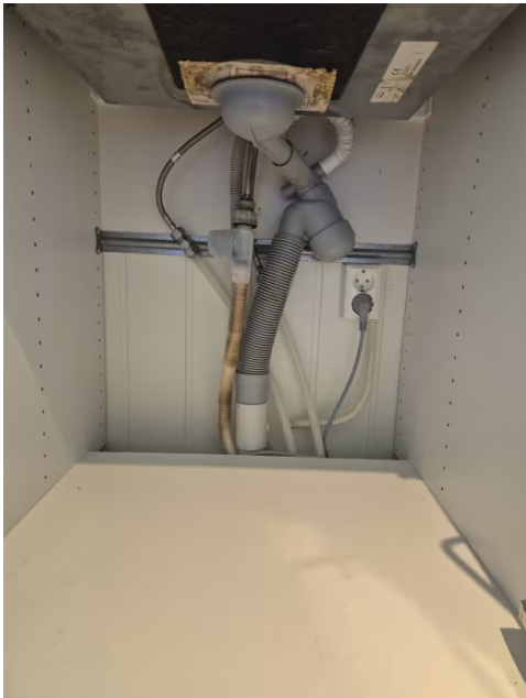
Viser vann- og avløpsinstallasjoner under kjøkkenkum.
