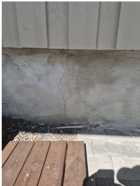
Viser riss/ sprekker i grunnmuren
