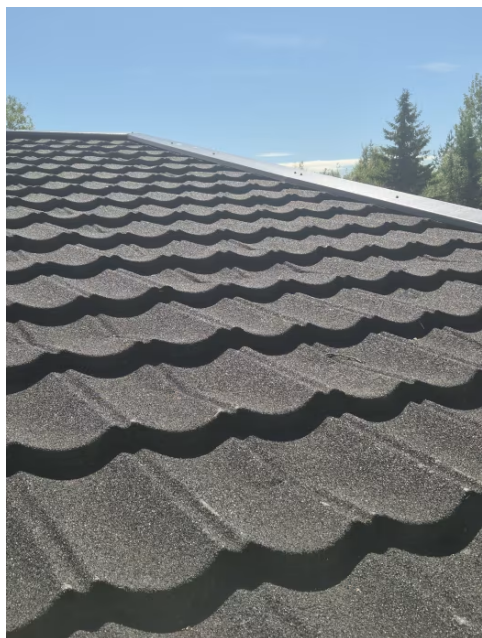
Viser område med bulker i takplater.
