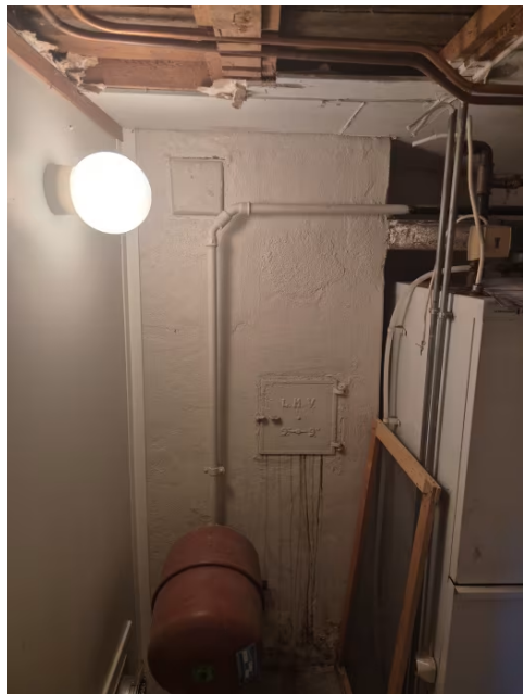
Viser feiluke i kjeller.
