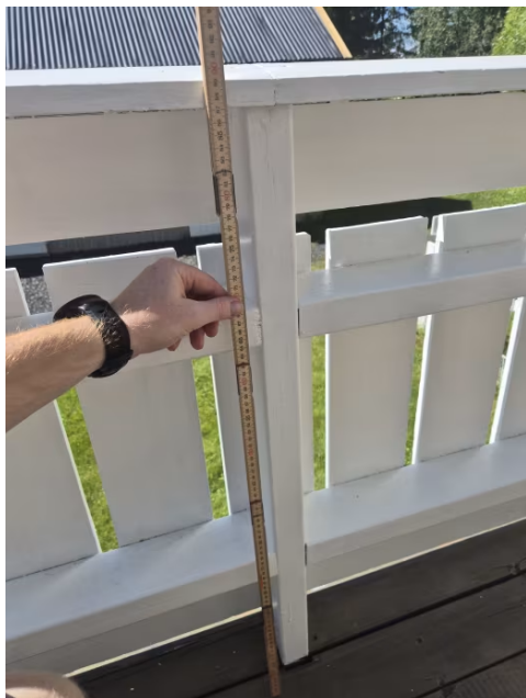
Viser rekkverkshøyde, høyde rekkverk målt til 91 cm.
