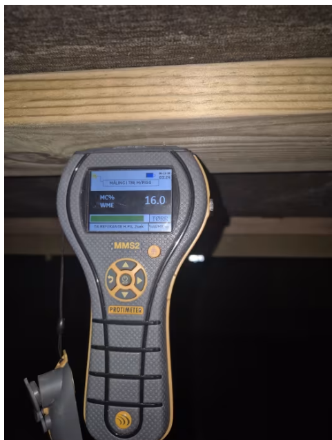
Viser fuktmåling i treverk, måling viser 16,0 %.
