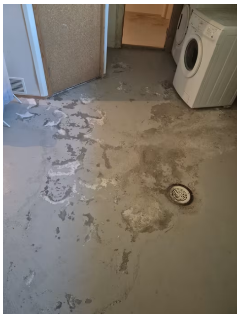
Viser eksempel av salt/kalutslag på gulv i kjeller.
