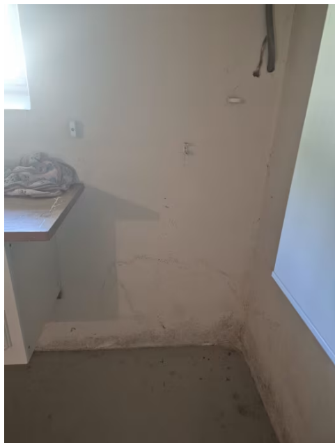
Viser riss/ sprekker i grunnmuren.
