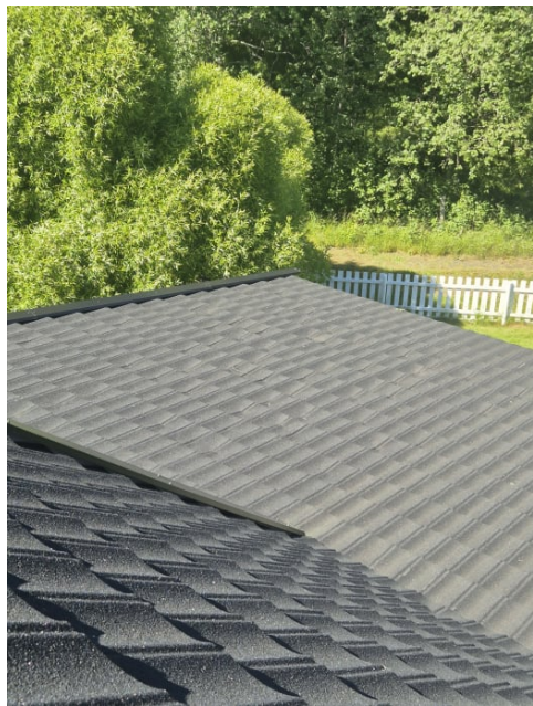
Viser område med bulker i takplater.
