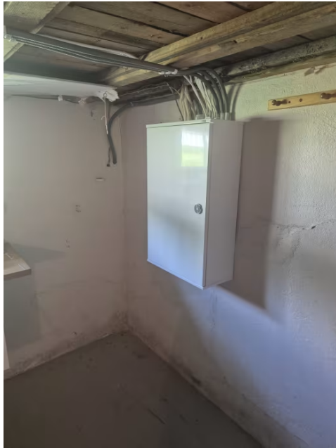
Viser plassering av sikringsskap i kjeller.
