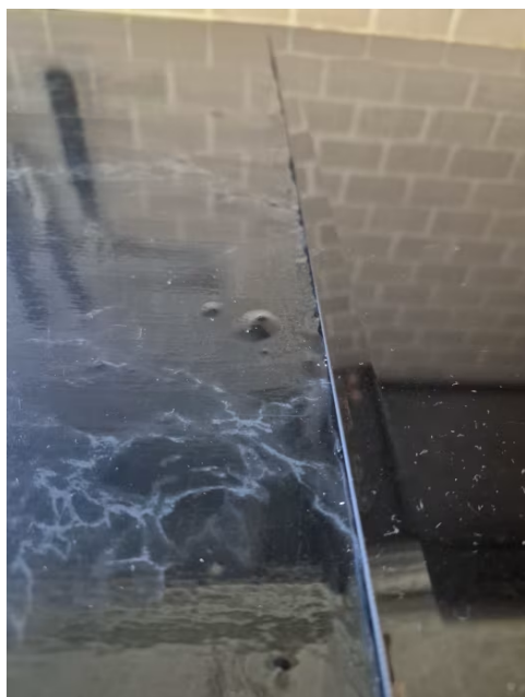
Viser eksempel av blemmer på foliert benkeplate.
