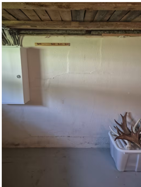
Viser riss/ sprekker i grunnmuren.
