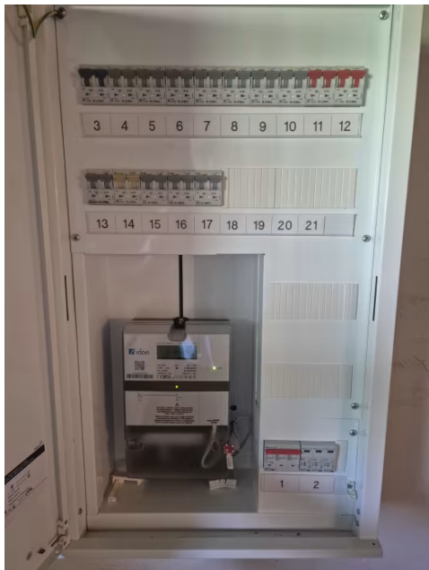
Viser sikringsskap med elektronisk strømmåler, 63A hovedsikring, overspenningsvern og automatsikringer.
