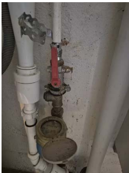
Viser plassering av hovedstoppekran i kjeller.
