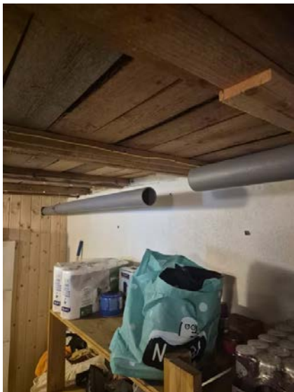
Viser område hvor avløpsrør er kappet.
