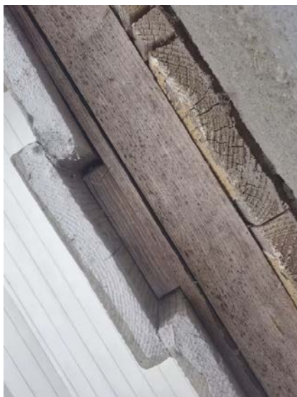
Viser eksempel av manglende lufting av kledning.
