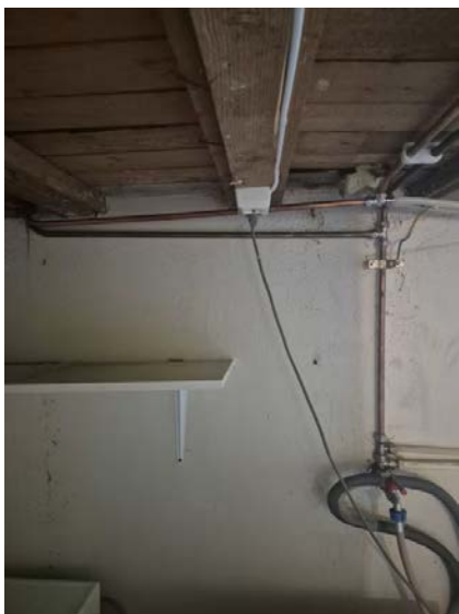
Viser eksempel av utførselen vannrør og ufagmessig utførelse.
