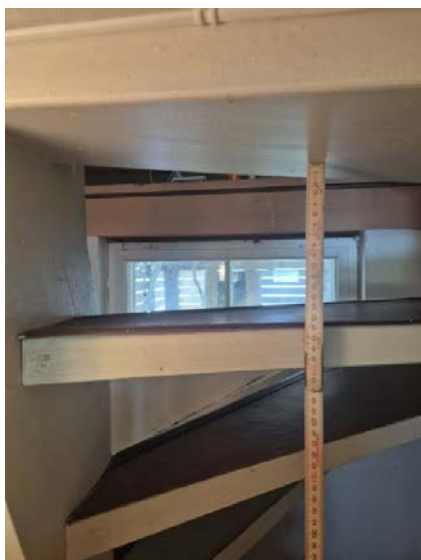
Viser åpninger mellom trinn.
