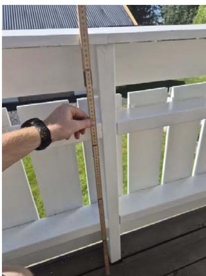
Viser rekkverkshøyde, høyde rekkverk målt til 91 cm.
