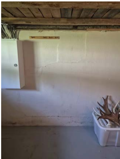
Viser riss/ sprekker i grunnmuren.
