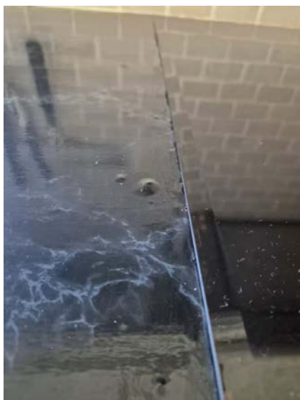
Viser eksempel av blemmer på foliert benkeplate.
