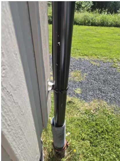
Viser nedløpsrør med buling/skade.
