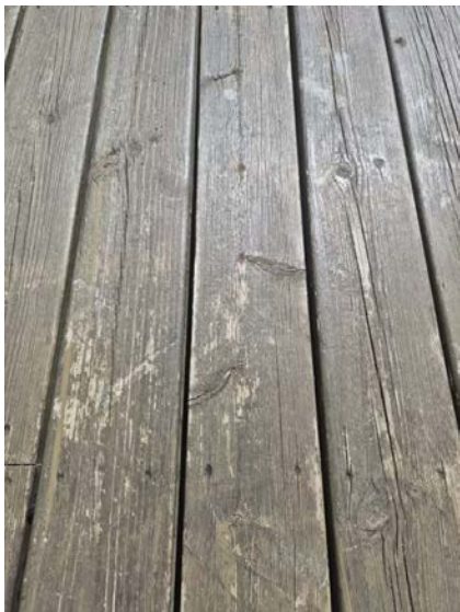
Viser terrassegulv med behov for overflatebehandling.
