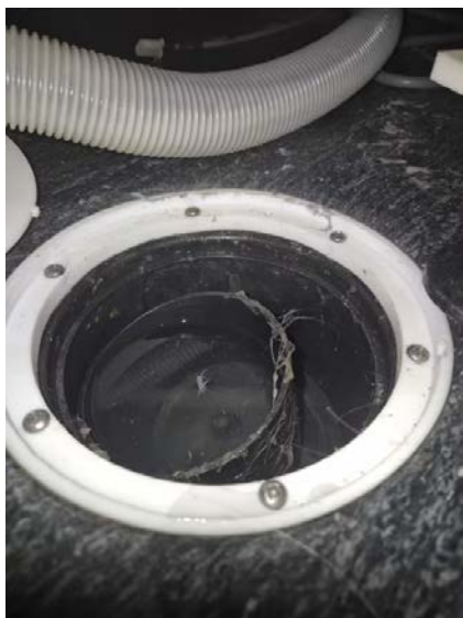
Viser bilde av fjernet vannlås, belegg ikke ført under klemring.
