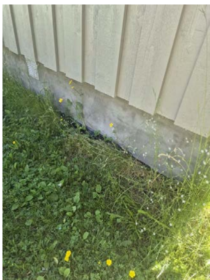
Viser etablert grunnmursplast og topplust, grunnmursplast og topplust bør være etablert over terrengnivå.
