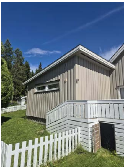
Viser raftekasse og vindskier med manglende overflatebehandling.
