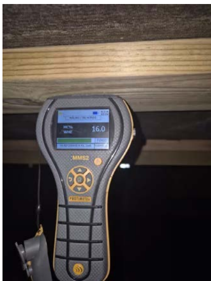
Viser fuktmåling i treverk, måling viser 16,0 %.
