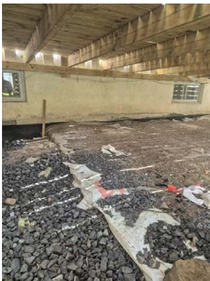
Viser område med manglende topplist.
