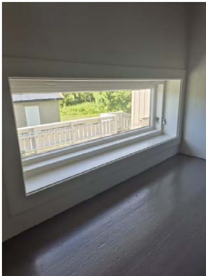
Viser varevindu i trapp 2. etasje med manglende innervindu.
