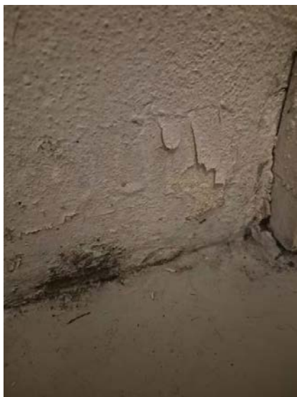
Viser eksempel av område i kjeller med sulfatskade (salt/kalkutslag).
