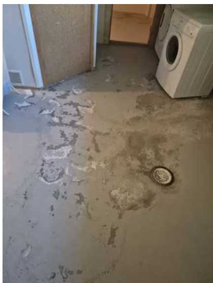
Viser eksempel av område med mineralutslag (salt/kalkutsalg).
