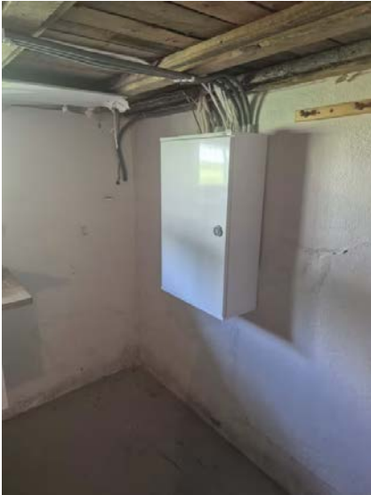
Viser plassering av sikringsskap i kjeller.
