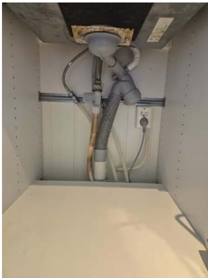
Viser vann- og avløpsinstallasjoner under kjøkkenkum.
