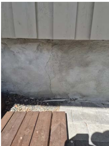
Viser riss/ sprekker i grunnmuren
