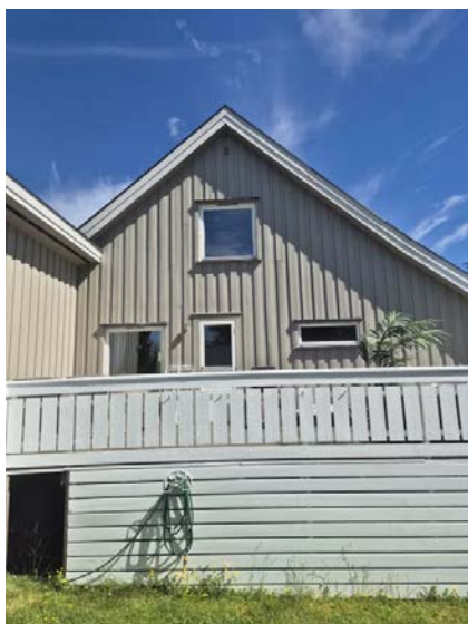
Viser eksempel av område med mange endeskjøter på kledning.
