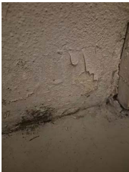
Viser eksempel av område med mineralutslag (salt/kalkutsalg).
