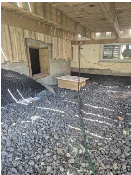
Viser område med manglende topplist.
