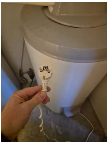
Viser plugg/støpsel, ingen tegn til varmegang.
