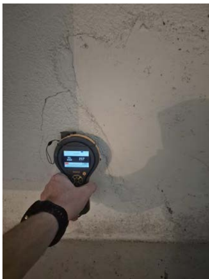
Viser indikasjoner på fukt i kjellergulv og nedre del av grunnmur med bruk av fuktmåler.
