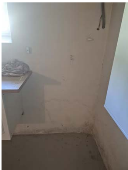
Viser riss/ sprekker i grunnmuren.
