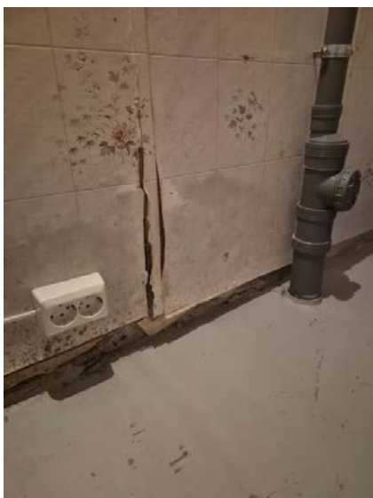
Viser område med skade i vegg.
