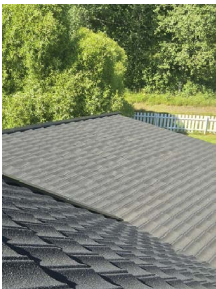
Viser område med bulker i takplater.
