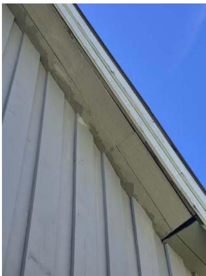
Viser gesimskasse og vindskier med manglende overflatebehandling.
