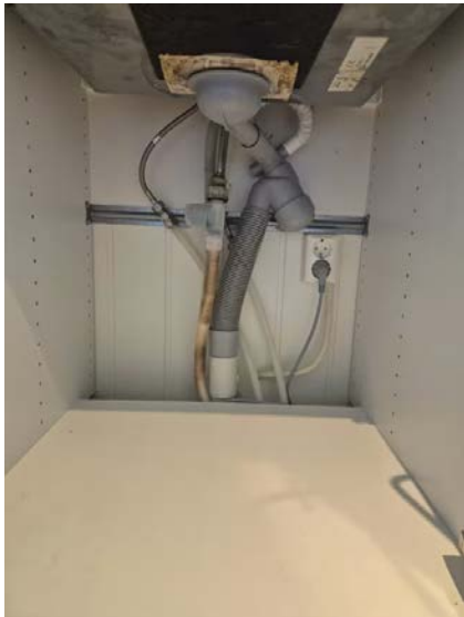
Viser vann- og avløpsinstallasjoner under kjøkkenkum.
