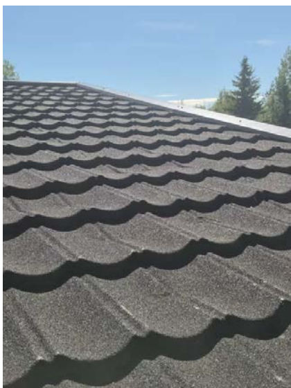
Viser område med bulker i takplater.
