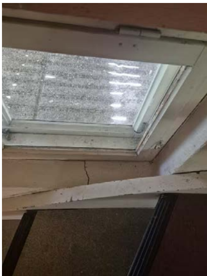
Viser varevindu i trapp kjeller med bruksslitasje på ramme og karm.
