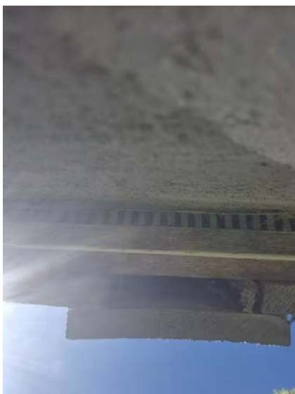
Viser manglende tetting mot mos ved bruk av lusing/kloss.
