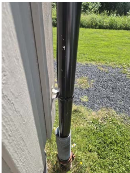
Viser nedløpsrør med buling/skade.
