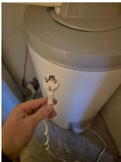
Viser plugg/støpsel, ingen tegn til varmegang.
