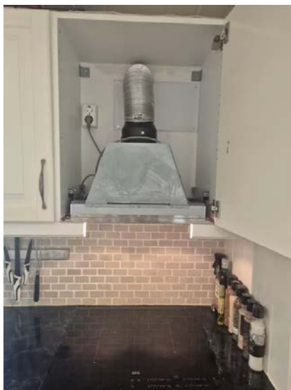
Viser ventilator med mekanisk vifte.
