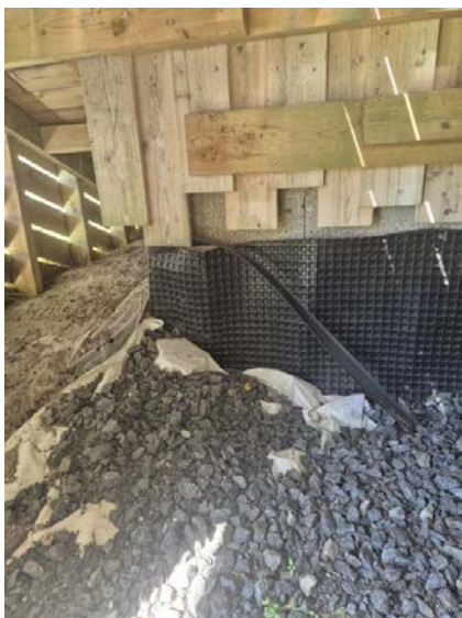
Viser område med manglende topplist.
