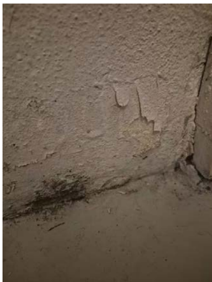
Viser eksempel av salt/kalutslag på innvendig vegg i kjeller.
