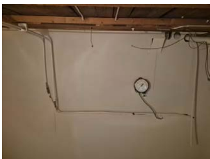
Viser eksempel av utførselen vannrør og ufagmessig utførelse.
