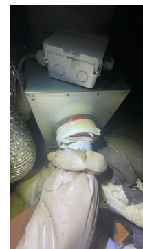
Provisorisk rørtilkopling sentralvifte
