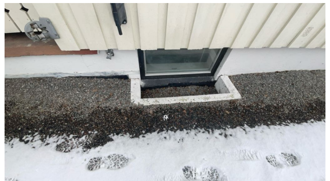
Stedvis synlig fuktsperre på muren
