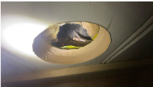
Råteskadet svill og plastfolie i vegg
