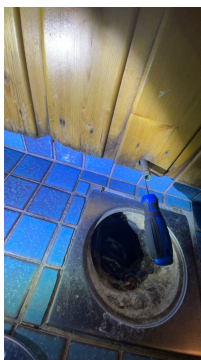
Sluk m/rustne skruer. Panelvegg i våtsone uten tettesjikt
