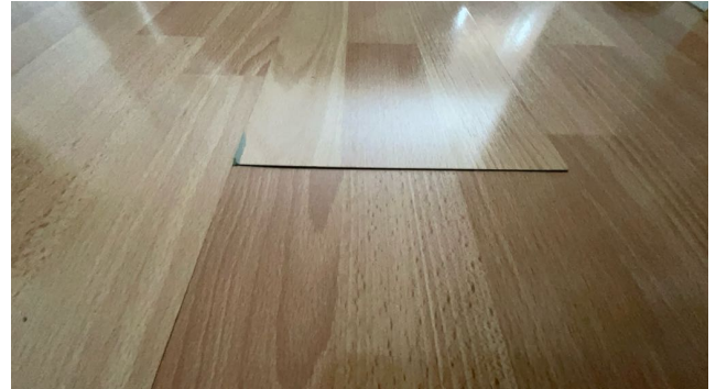
Oppsprekk laminatskjøt kjøkken
