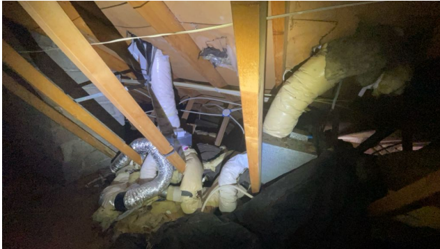
Ventilasjonskanaler/vifter hvor et uisolert har falt ned (til venstre i bildet)
