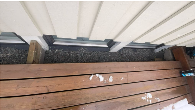
Åpninger langs vegg ved kjellervinduer
