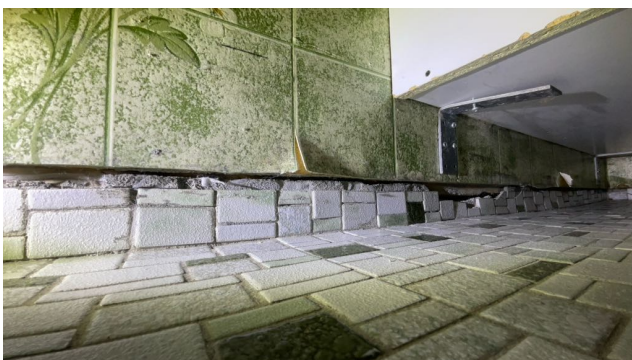
Løst tapet og fliser
