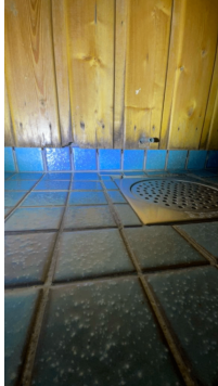
Fuktbelastet panel med litt råtedannelse i nedkant
