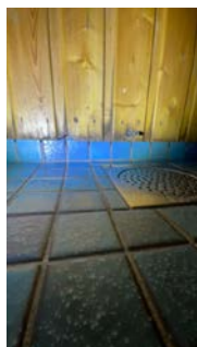
Fuktbelastet panel med litt råtedannelse i nedkant
