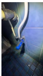
Utett rørgjennomføring for servant (våtsone)
