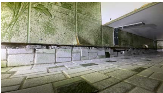
Løstnet tapet og fliser
