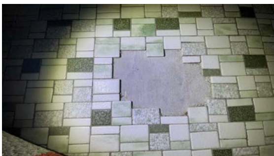
Løse fliser flere steder
