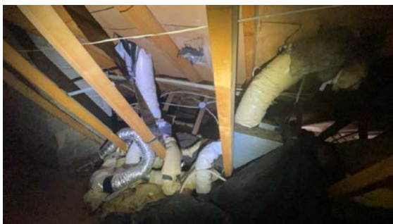
Ventilasjonkanaler/vifter hvor et uisolert har falt ned (til venstre i bildet)
