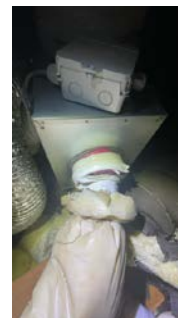
Provisorisk rørtilkopling sentralvifte
