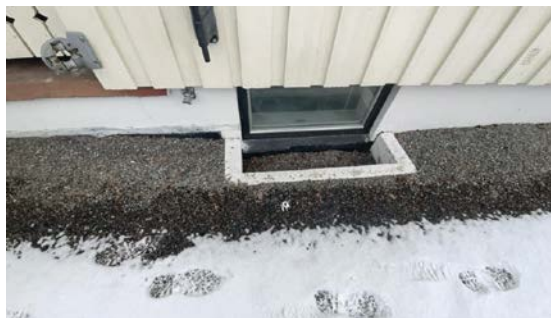
Stedvis synlig fuktsperre på muren
