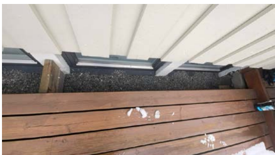
Åpninger langs vegg ved kjellervinduer
