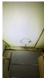
Litt sprekker i puss på pipen ved kjellerkjøkken
