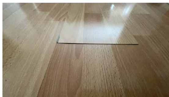
Oppsprekk laminatskjøt kjøkken
