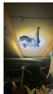
Gjennomføring ikke ibruk (mulig har det løse ventilasjonsrøret gått opp hit).
