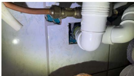
Membran kan påvises ved rørgjennomføringer (men uten mansjetter)
