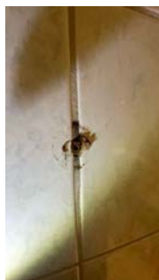
Åpne skruer/pluggeskruehull dusjhjørne
