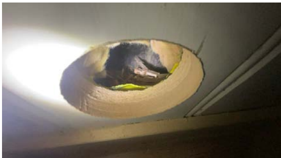
Råteskadet svill og plastfolie i vegg
