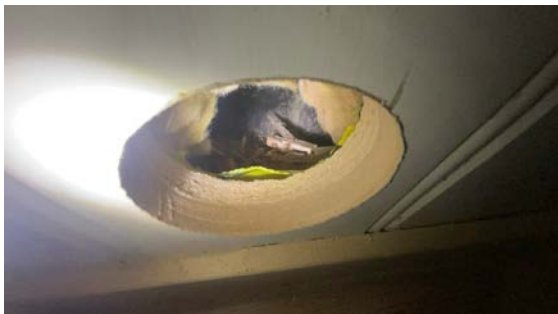
Råteskadet svill og plastfolie i vegg
