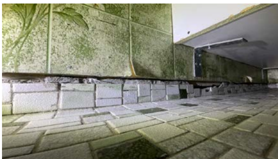
Løst tapet og fliser
