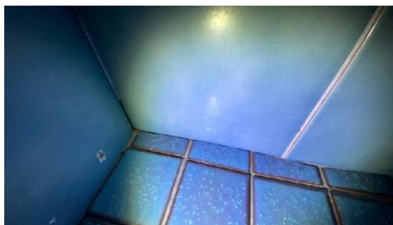
Riss i fliser
