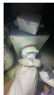
Provisorisk rørtilkopling sentralvifte
