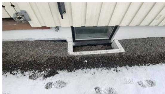
Stedvis synlig fuktsperre på muren
