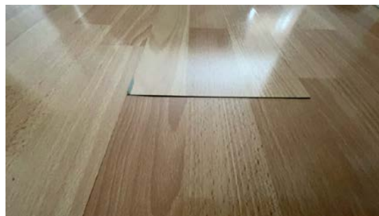
Oppsprekk laminatskjøt kjøkken
