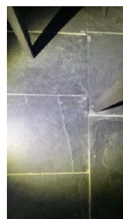
Løsninger i fuger flisfelt under vedovner
