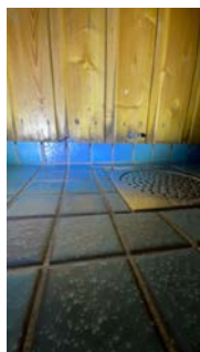
Fuktbelastet panel med litt råtedannelse i nedkant
