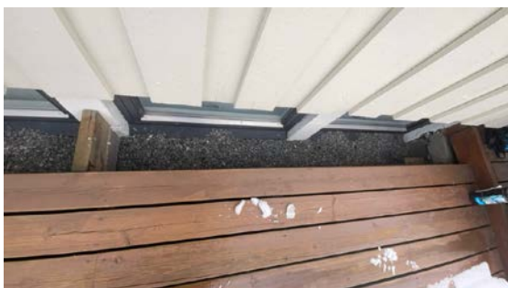
Åpninger langs vegg ved kjellervinduer
