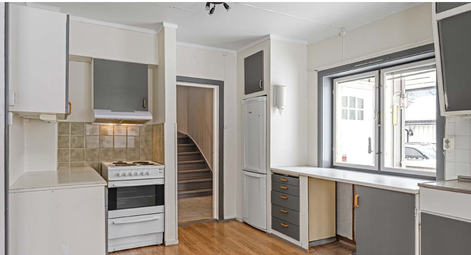
Kjøkkenet har fått TG3 i tilstandsrapporten da det er påvist skader på overflater/kjøkkeninnredning utover normal slitasjegrad.
