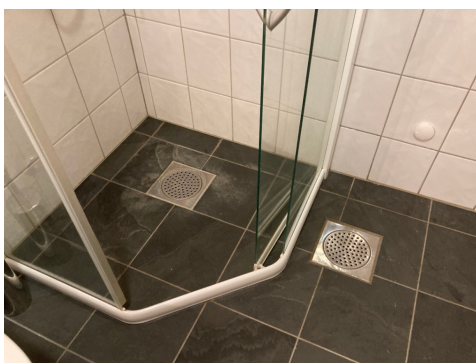
Sluk utenfor dusjsone
