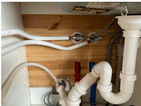
Røropplegg i skap under vask
