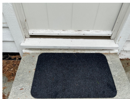
Inngangsdør fremstår som vær-slitt. Normalt vedlikehold må påregnes.
