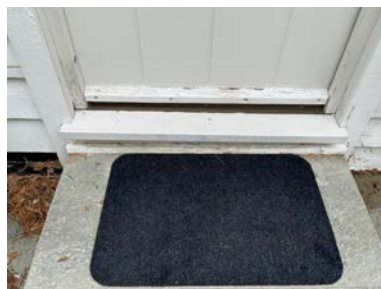
Inngangsdør fremstår som vær-slitt. Normalt vedlikehold må påregnes.
