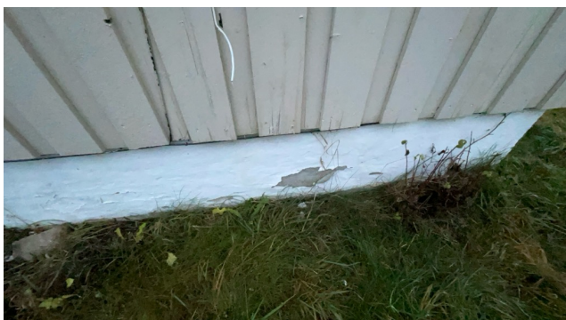
Stedvis behov for lokale utbedringer.
