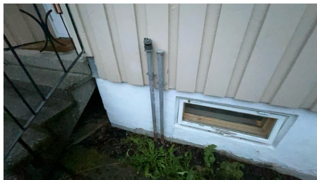
Synlige påfyllingsrør til tank.
