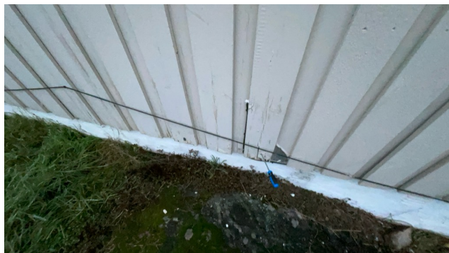
Påvist stedvis råteskader.
