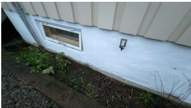
Stedvis behov for lokale utbedringer.
