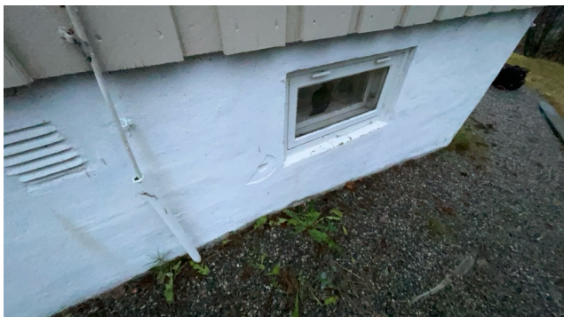
Stedvis behov for lokale utbedringer.
