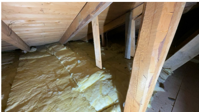
Det er begrenset/dårlig ventilering av takkonstruksjonen.
