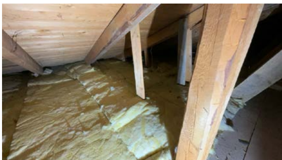
Det er begrenset/dårlig ventilering av takkonstruksjonen.
