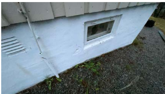
Stedvis behov for lokale utbedringer.
