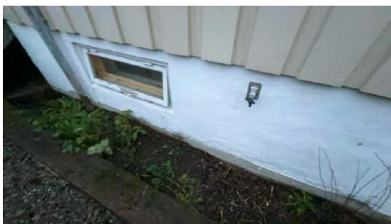
Stedvis behov for lokale utbedringer.
