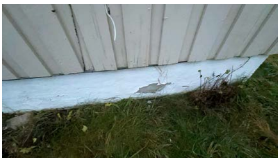
Stedvis behov for lokale utbedringer.
