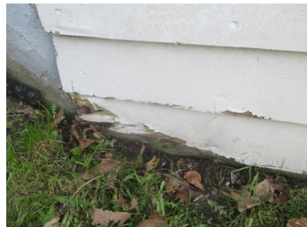
Noe råteskader på endeveggen.
