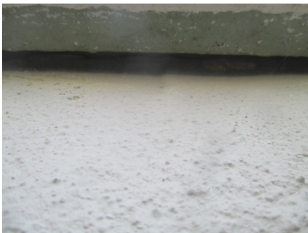
Lite/ingen lufting bak opprinnelig kledning.
