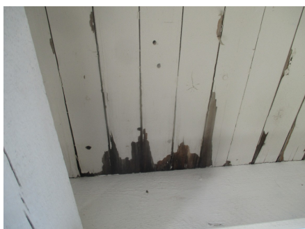
Fuktskader på undertaket ved overbygget veranda.
