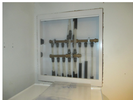
Fordelerskapet er plassert på vaskerommet.
