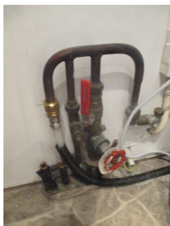
Innvendig stoppekran på vaskerommet
