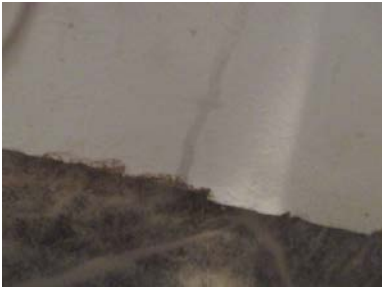
Noe fuktskader i bunnen av veggplater.
