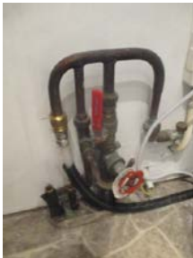
Innvendig stoppekran på vaskerommet
