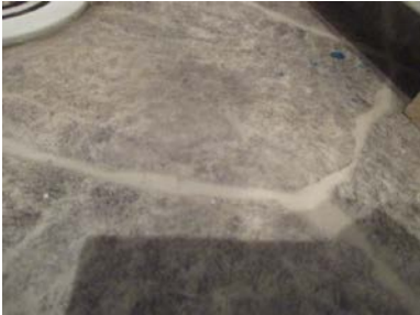
Belegget løsnet noe fra underlaget.
