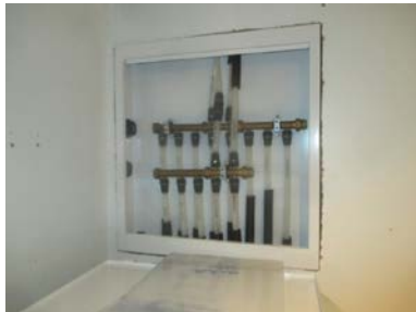
Fordelerskapet er plassert på vaskerommet.
