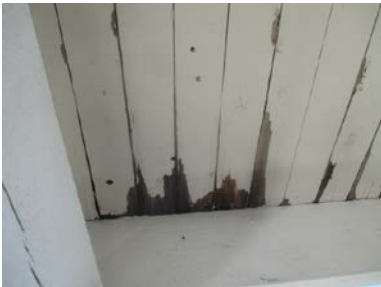
Fuktskader på undertaket ved overbygget veranda.
