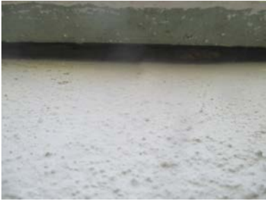
Lite/ingen lufting bak opprinnelig kledning.
