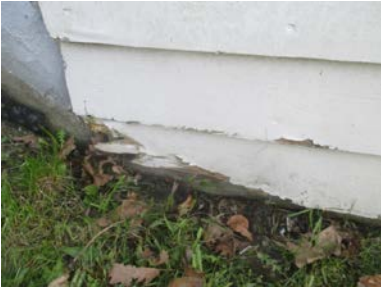
Noe råteskader på endeveggen.
