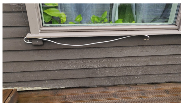
Løs kabel utendørs.
