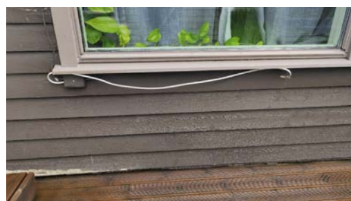
Løs kabel utendørs.
