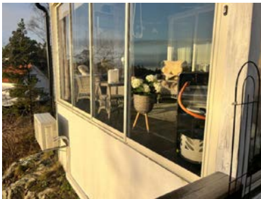
Balkong mangler rekkverk
