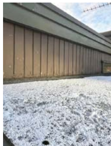
Kledning i dårlig stand, begynnende råteskader.
