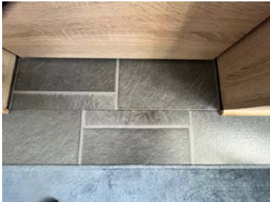
Ufagmessig skjøt på laminatgulv på soverom
