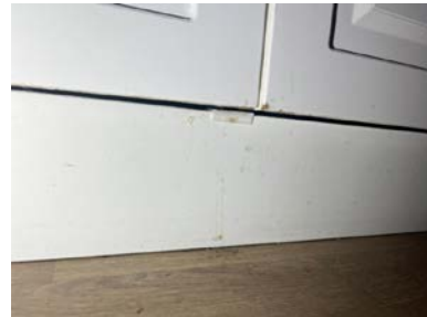
Slitasje på skapfront
