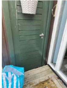
Noe malingsslitt overflate på bør til bod.
