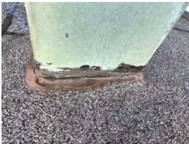
Liten sprekk i overgang til luftehatt.
