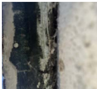
Inge lufting bak kledningen.
