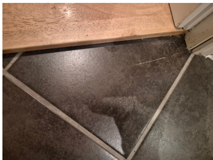
Gulvflis med bom og sprekk.
