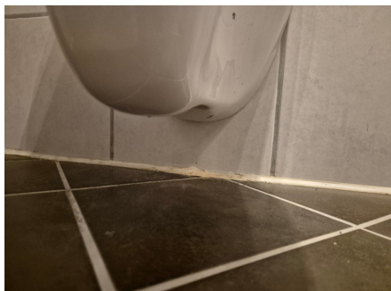
Manglende drencspalte under toalett.
