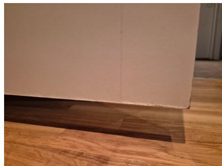
Fuktsveller i bunn av dørblad.
