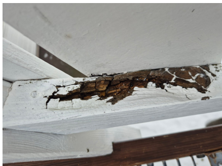
Råteskader i rekkverk.
