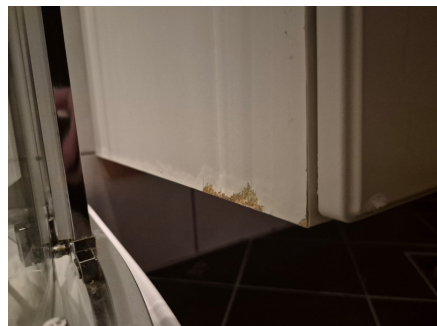
Svelleskader på siden av innredning.
