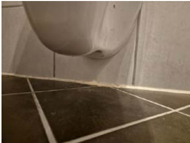
Manglende drencspalte under toalett.
