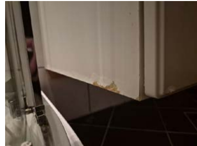
Svelleskader på siden av innredning.
