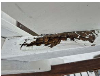
Råteskader i rekkverk.
