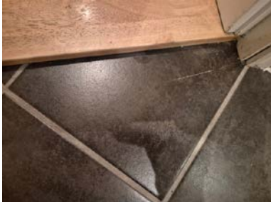
Gulvflis med bom og sprekk.
