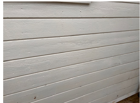
Råteskade i kledning på fasade sør/vest
