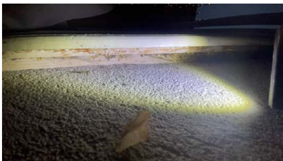
Utlufting i bunn av utlektning blokkert med horisontal lekt.
