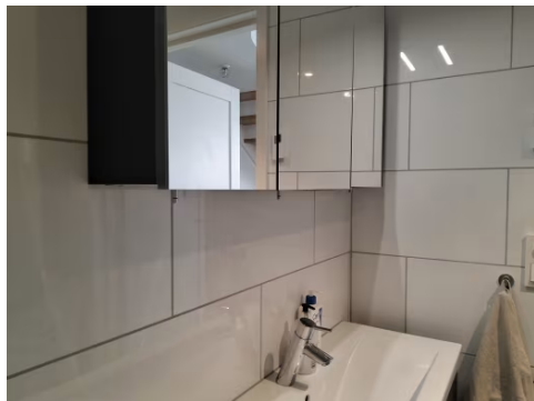
Det registreres skjevheter i speilskap over servant.
