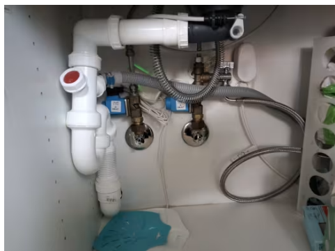
Synlige avløpsrør av plast i leiligheten.
