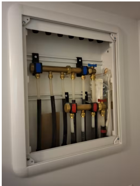
Fordelerskap med stoppekraner er plassert på bod.
