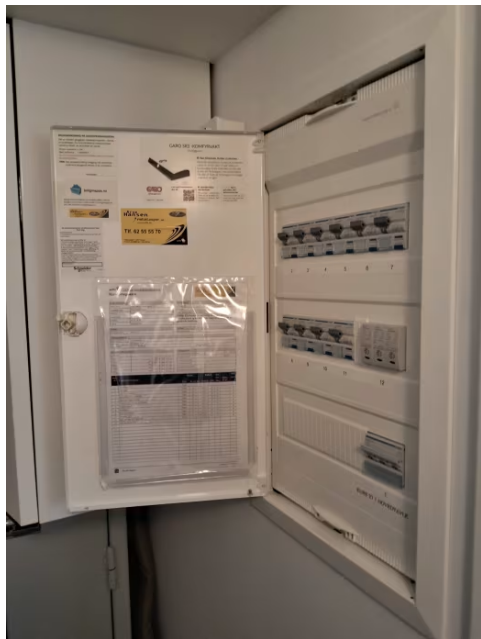
Sikringsskap er plassert på bod.
