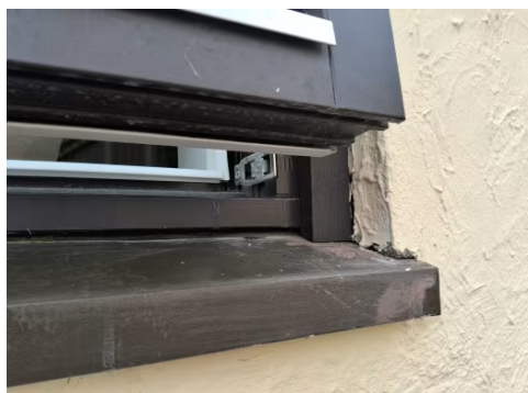
Det er lav/ingen klaring mellom utvendig listverk og beslag under vinduet.
