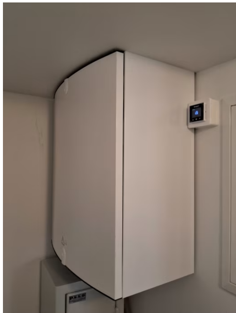
Ventilasjonsaggregat er plassert på bod.
