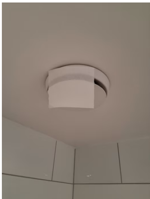
Avtrekkseffekten er testet med papir.
