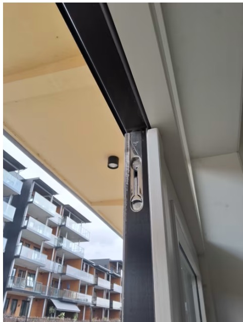
Entrédør henger og har slitt bort maling på deler av sidefelt.
