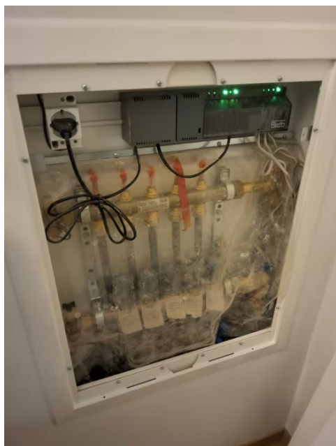
Sentral for vannbåren gulvvarme er plassert på bod.
