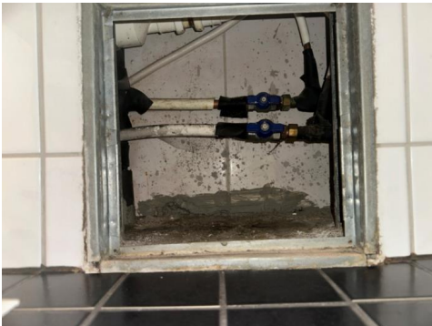
Stoppekraner plassert på bad
