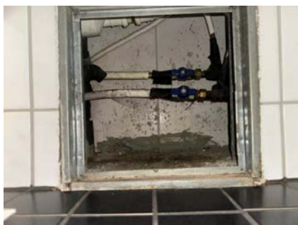
Stoppekraner plassert på bad
