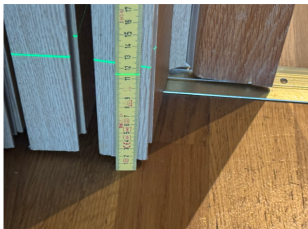
Stuegulvet har en høydeforskjell på ca. 32 mm
