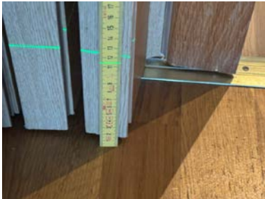
Stuegulvet har en høydeforskjell på ca. 32 mm
