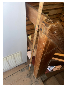
Lav rekkverkshøyde og store åpninger.
