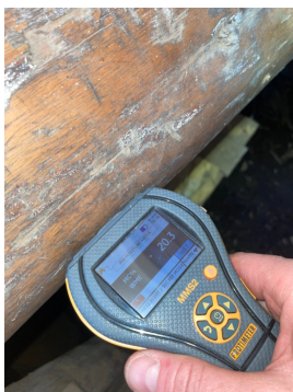
Det måles fuktverdier med ytterligere skadepotensiale.
