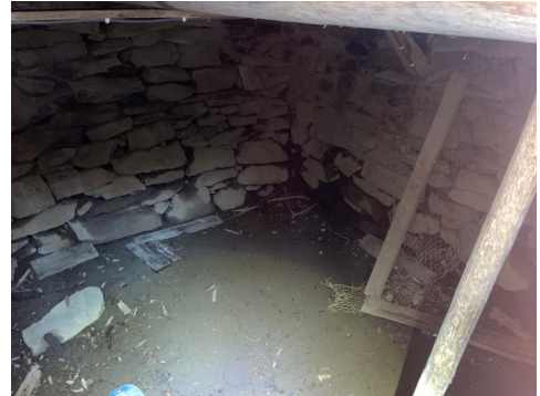
Synlig fuktinnsig i nedre del av mur og på gulv.
