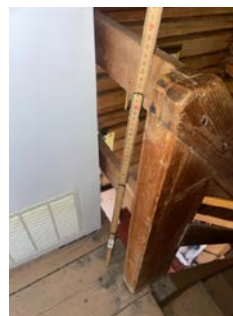
Lav rekkverkshøyde og store åpninger.
