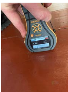
Stikkprøver med fuktmåling av gulv i oppholdsrom.
