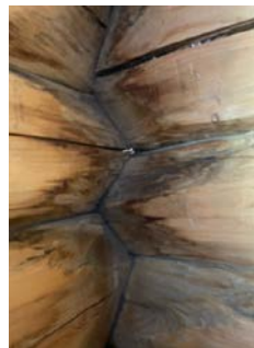
Fuktmerker i hjørner og stedvis antydning til svertesopp.
