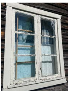
Sprekker i glass og værslitte/oppsprukket treverk.
