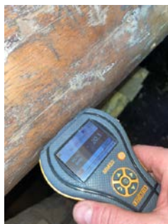
Det måles fuktverdier med ytterligere skadepotensiale.
