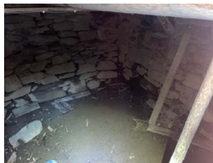
Synlig fuktnisig i nedre del av mur og på gulv.
