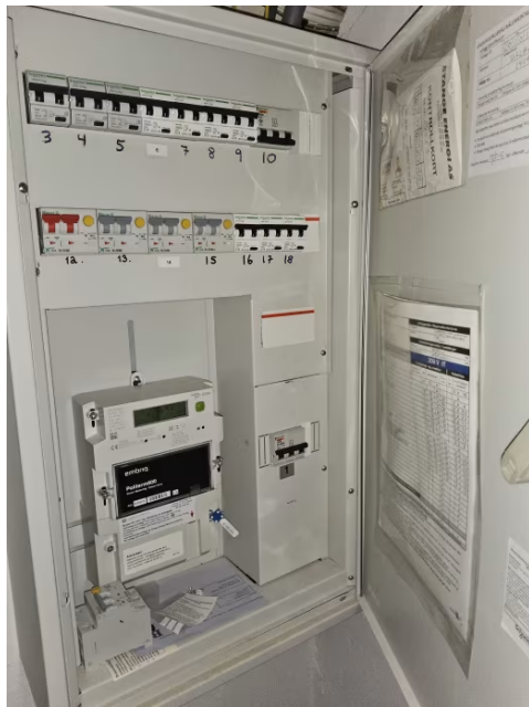
Sikringsskap er plassert i kjellergang.
