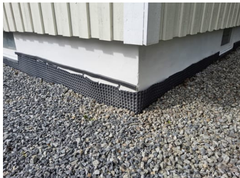
Deler av fuktsperren mangler topplist, og fuktsperren har stedvis løsnet fra topplisten.
