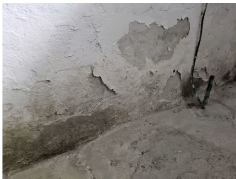
Det registreres salt/kalkutsalg på grunnmur i vaskekjeller.
