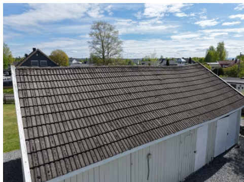
Skjevheter i takkonstruksjon.
