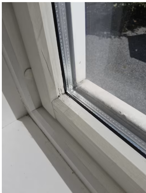
Symptomer på kondens registreres i enkelte vinduskarmer (krakelert maling).
