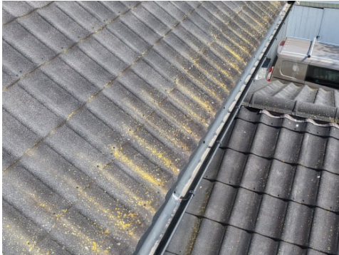
Det registreres noe mosegroing på takplater.
