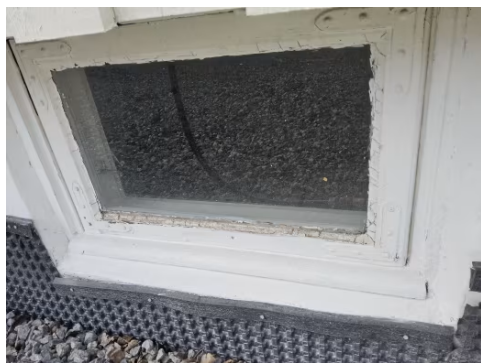
Oppsprekte kittfalsen på kjellervindu.
