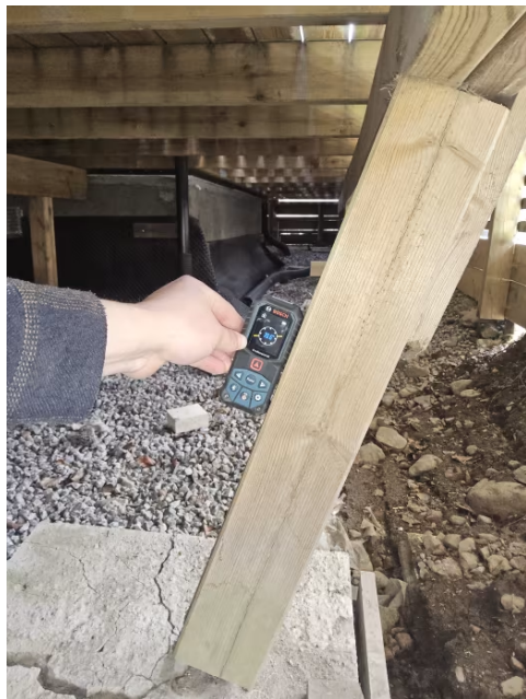
Vesentlige skjevheter på bæresøyle til terrasse.
