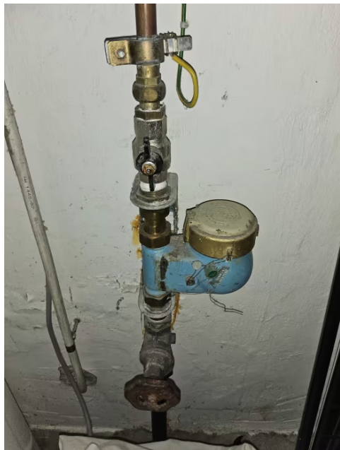
Hovedestoppekran er plassert i vaskekjeller.
