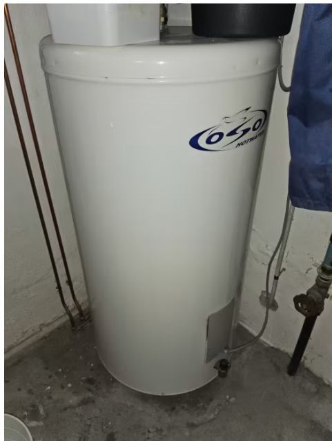
Varmtvannsbereder er plassert i vaskekjeller.
