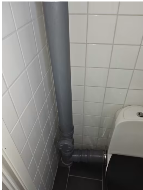
Stakeluke er plassert i toalettrom.
