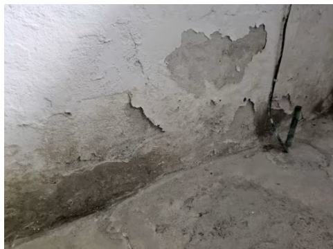
Salt/kalkutslag i kjeller.
