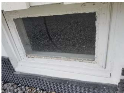
Oppsprekte kittfalsen på kjellervindu.
