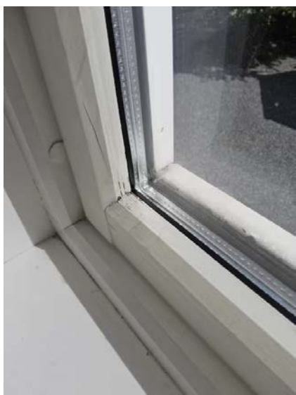
Symptomer på kondens registreres i enkelte vinduskarmen (krakelert maling).
