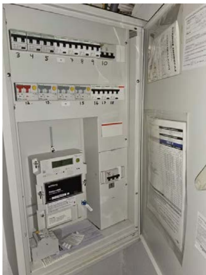
Sikringsskap er plassert i kjellergang.
