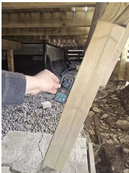
Vesentlige skjevheter på bæresøyle til terrasse.
