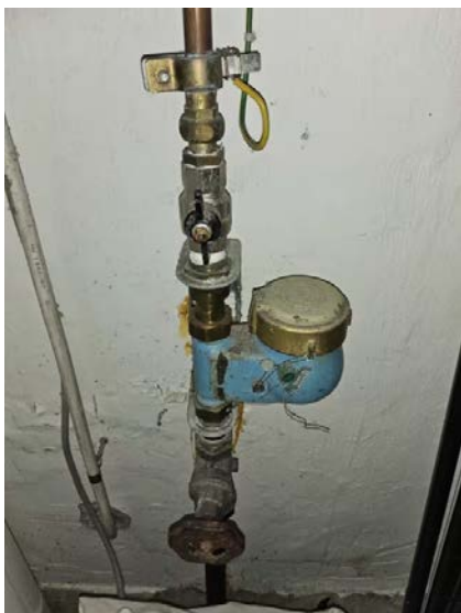
Hovedestoppekran er plassert i vaskekjeller.
