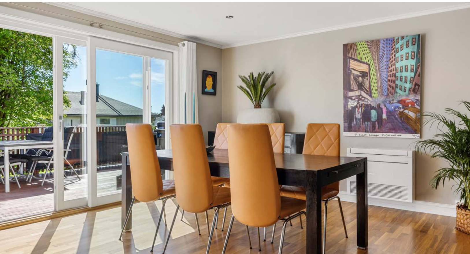
Varmepumpe er montert i spisetua for jevn varme.
