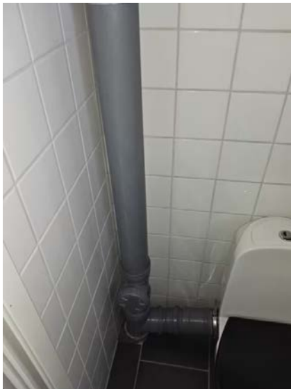
Stakeluke er plassert i toalettrom.
