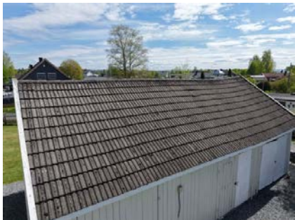
Skjevheter i takkonstruksjon.
