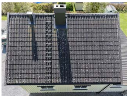
Det er etablert takstige til pipe.
