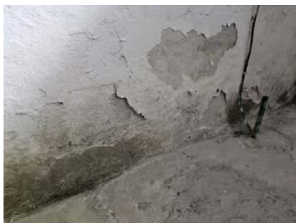
Salt/kalkutslag i kjeller.
