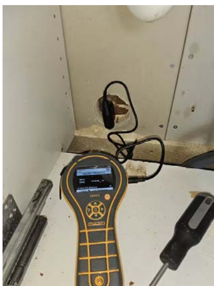
Bilde fra fuktmåling i veggkonstruksjon tilstøtende våtsone.
