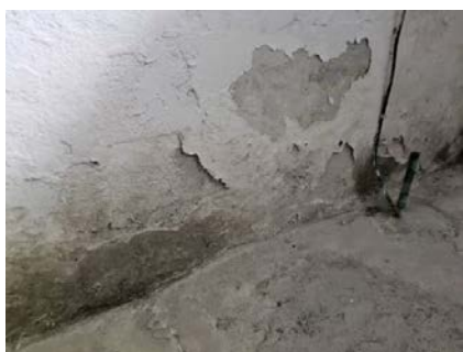
Det registreres salt/kalkutslag på grunnmur i vaskekjeller.
