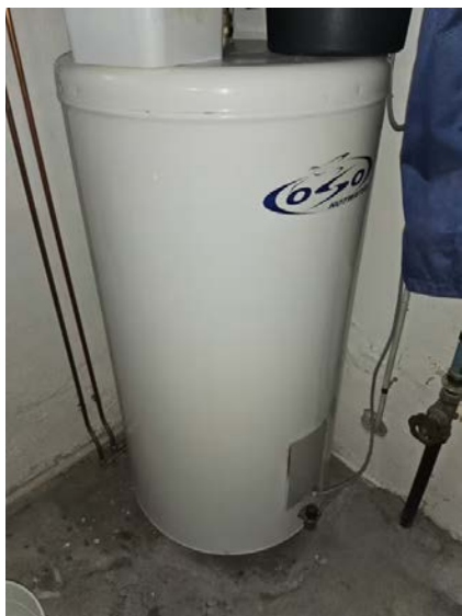
Varmtvannsbereder er plassert i vaskekjeller.
