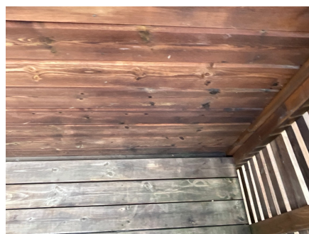
Mangler beslag mellom veranda og vegg.
