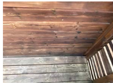
Mangler beslag mellom veranda og vegg.
