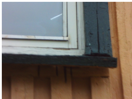
Råteskader på vindu i ene stuen
