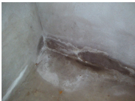
Synlige fuktmerker og saltutslag.
