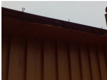
Vindskie mangler på tilbygget.
