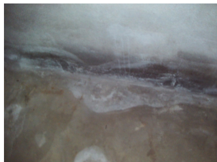
En del fuktvandring i nederste del av grunnmur og støpte kjellergulv.
