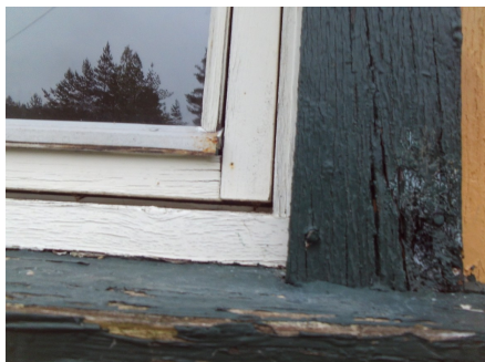
Slitte på utvendig karm og ramme.
