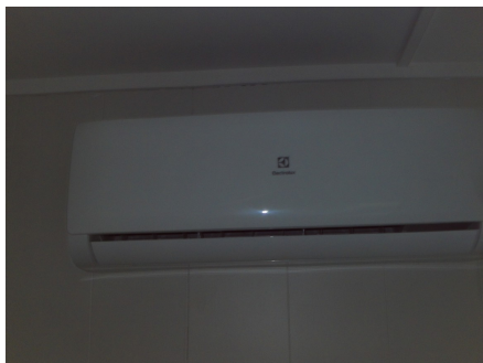
Varmepumpe i stue.
