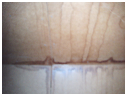
Noe fukt/kondensmerker på ene knekottet.
