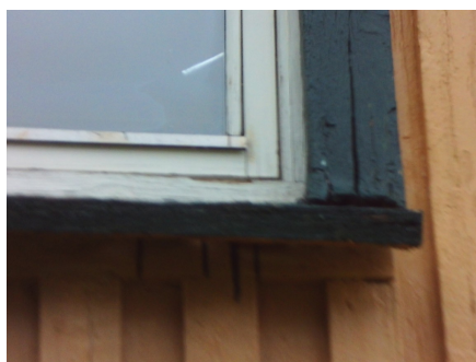
Noe råreskader på enkelte belistninger.
