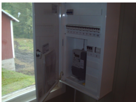
Nyere sikringsskap ved trappnedgang på loftet.
