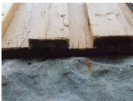
Lite tilgang på luft ved grunnmur
