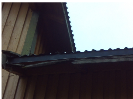
Takrenner mangler på opprinnelig del.
