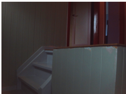
Mangler rekkverk på loftet.
