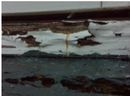
Større råteskader på ene pannebord for takrenner.
