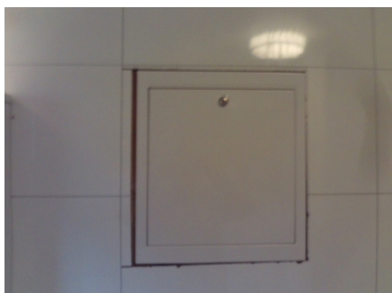
Fordelerskap på bad/vaskerom.
