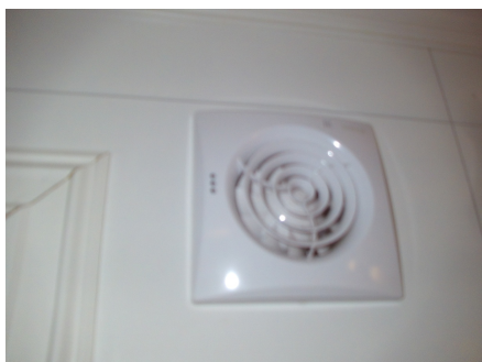
Vifte i ytterveggen.
