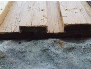
Lite tilgang på luft ved grunnmur
