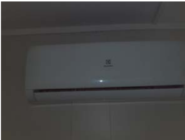
Varmepumpe i stue.
