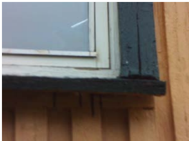
Noe råreskader på enkelte belistninger.
