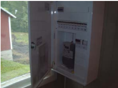
Nyere sikringsskap ved trappnedgang på loftet.
