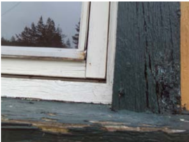
Slitte på utvendig karm og ramme.
