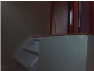
Mangler rekkverk på loftet.
