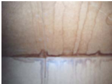
Noe fukt/kondensmerker på ene knekottet.
