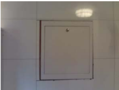
Fordelerskap på bad/vaskerom.
