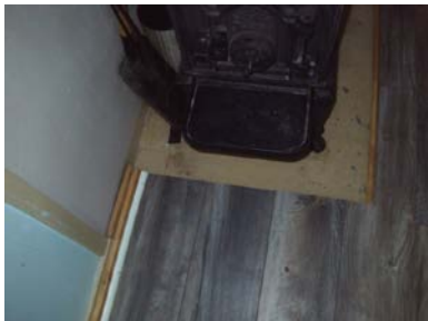
Lien dekkplate foran vedovn.
