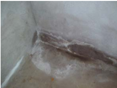
Synlige fuktmerker og saltutslag.
