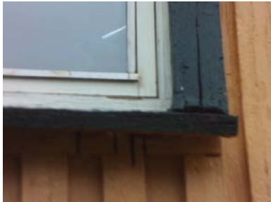
Råteskader på vindu i ene stuen
