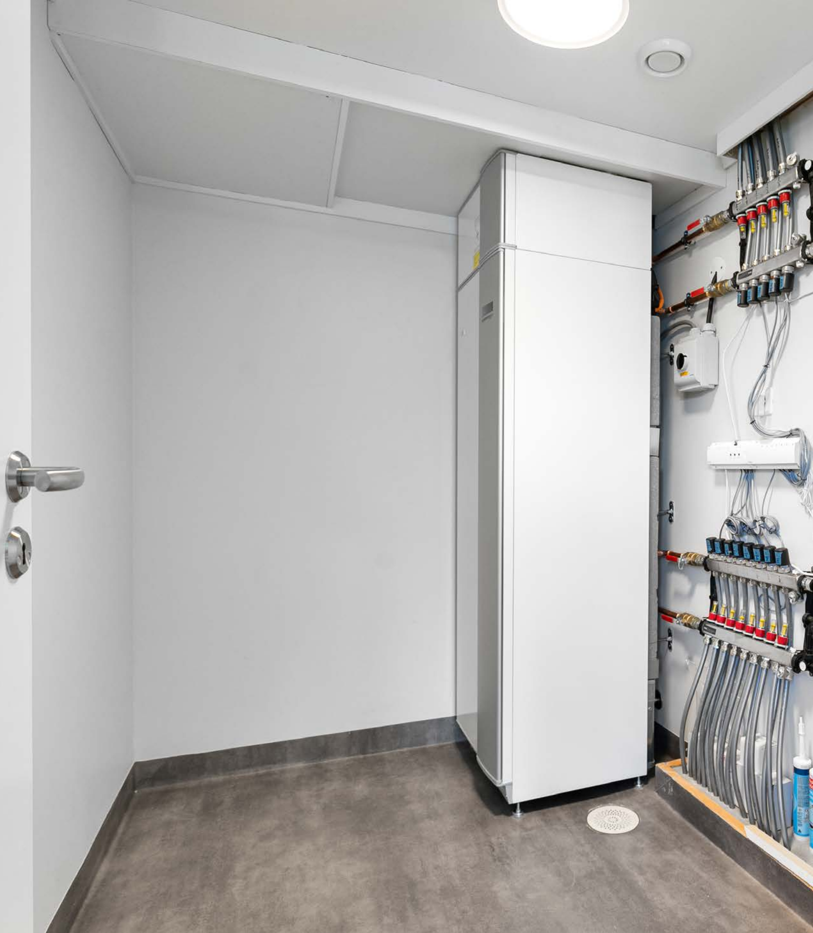
Bod/teknisk rom. Boligen har deilig vannbåren gulvvarme i alle gulv med energieffektiv luft-til-vann varmepumpe (NIBE 470).
