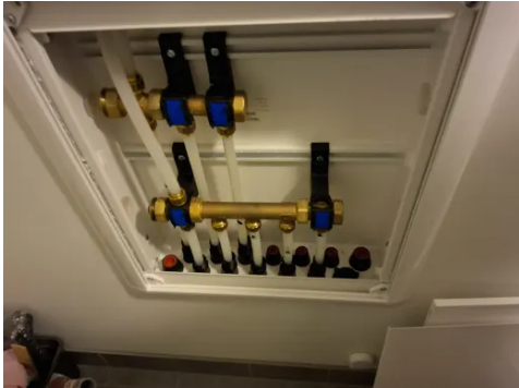
Fordelerskap for rør-i-rør.
