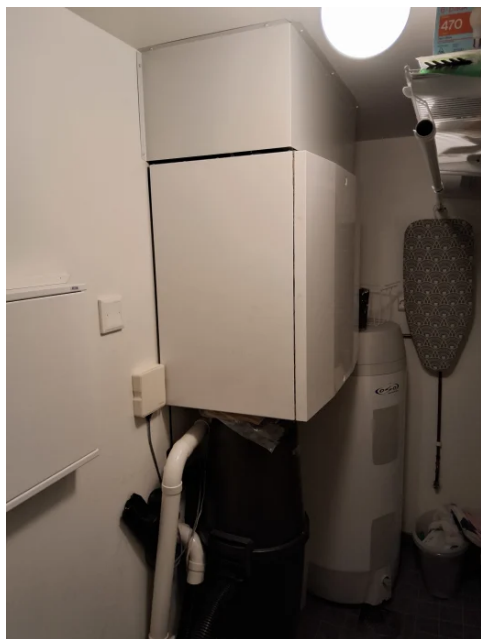
Ventilasjonsaggregat er plassert i bod/teknisk rom.
