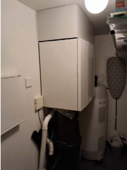
Ventilasjonsaggregat er plassert i bod/teknisk rom.
