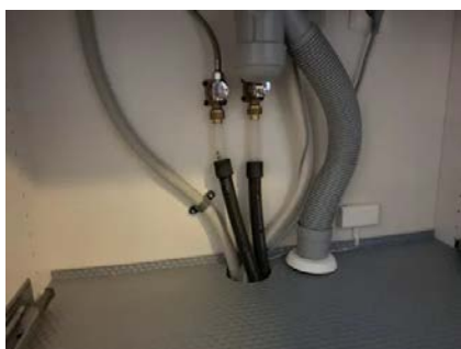
Boligen har synlige avløpsrør av plast.
