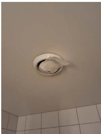
Avtrekkseffekten er testet med papir.
