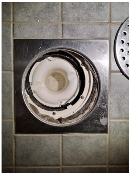
Det ble ikke avdekket avvik i overgang sluk/membran.
