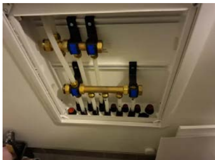
Fordelerskap for rør-i-rør.
