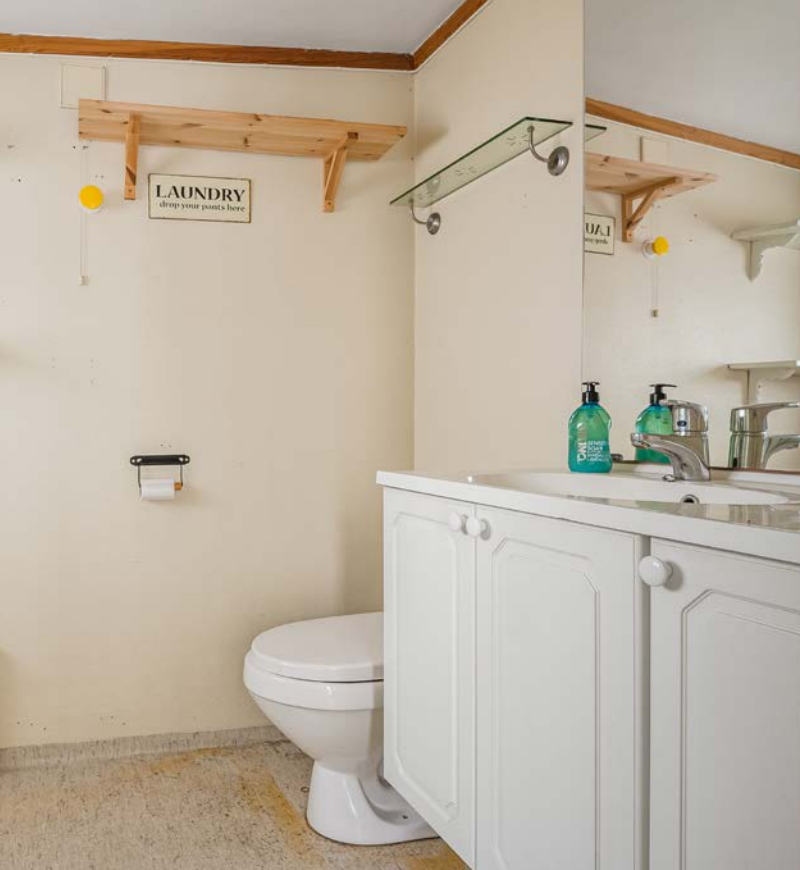
Badet er av eldre opprinnelse og må totalrenoveres.
