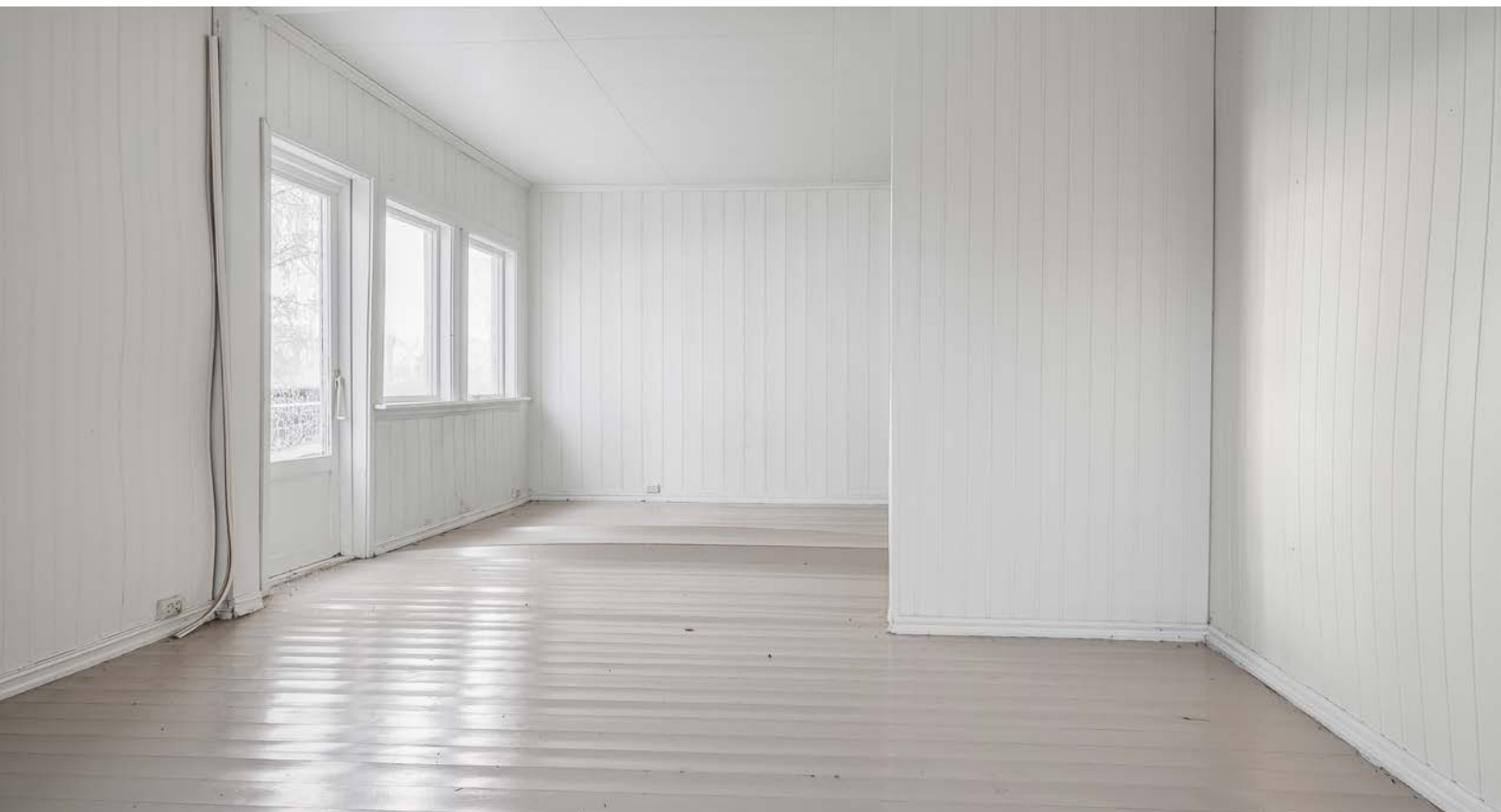
Gulvet i stuen bærer preg av de omfattende skadene i underlaget.
