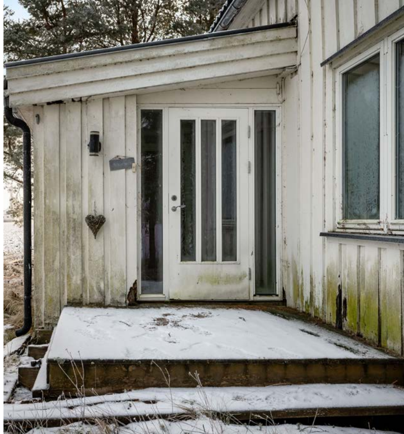
Påbygget del av boligen med råteskader.
