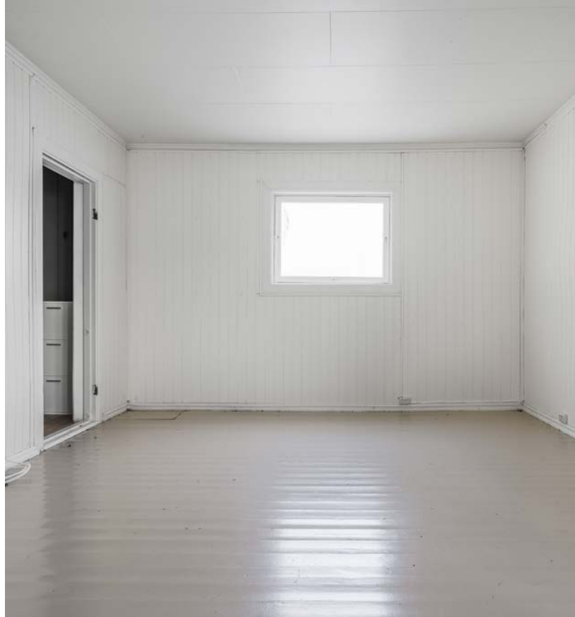
Boligen har et stort potensiale ved utbedring av skadene.
