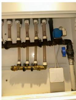
Samleskap med rørkurser og stoppekraner
