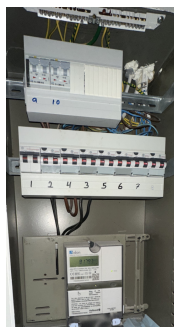
Sikringsskap med automatsikringer.
