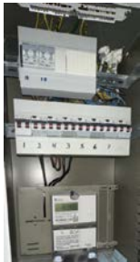
Sikringsskap med automatsikringer.
