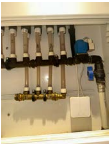
Samleskap med rørkurser og stoppekraner
