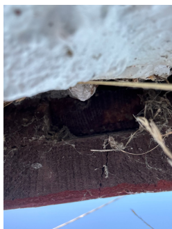
Mangelfull lufting bak kledning.
