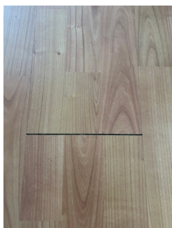
Laminatgulv i 1. etasje med sprekker i sammenføyninger.
