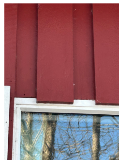
Ufagmessig avslutning av kledning over vindu.
