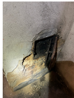
Pussavskalling på teglsteinspipe i kjeller.
