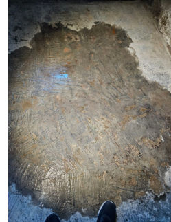
Fuktmerker på gulv under lekkasjepunkt i kjeller.
